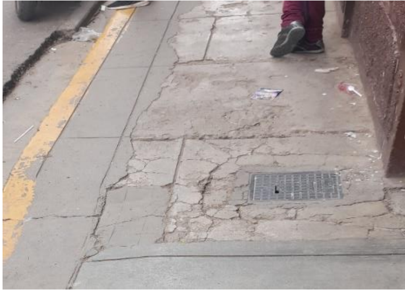
Figura N° 4.31. Estado de la vereda l Jr. Pisagua. Cdra. 5.
