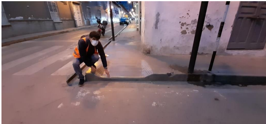
Figura N° 4.30. Estado de la Rampa en el Jr. Del Comercio Cdra. 05.
