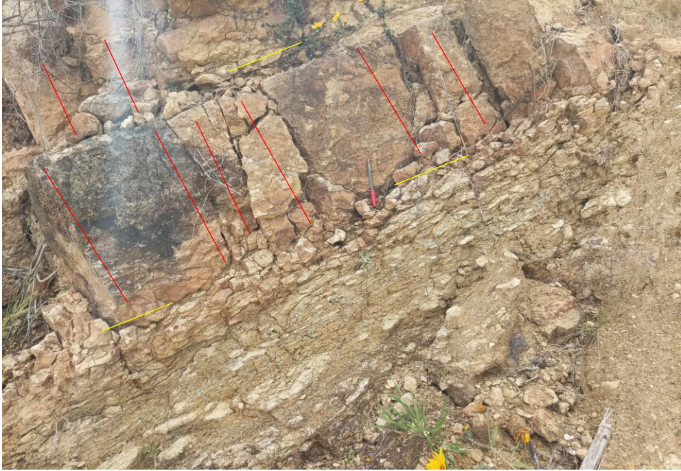
Foto 15. Sistema formado por dos familias de diaclasas en plano de estrato (Coordenadas UTM 783236 E, 9211232N) (Orientación 80°NE).
