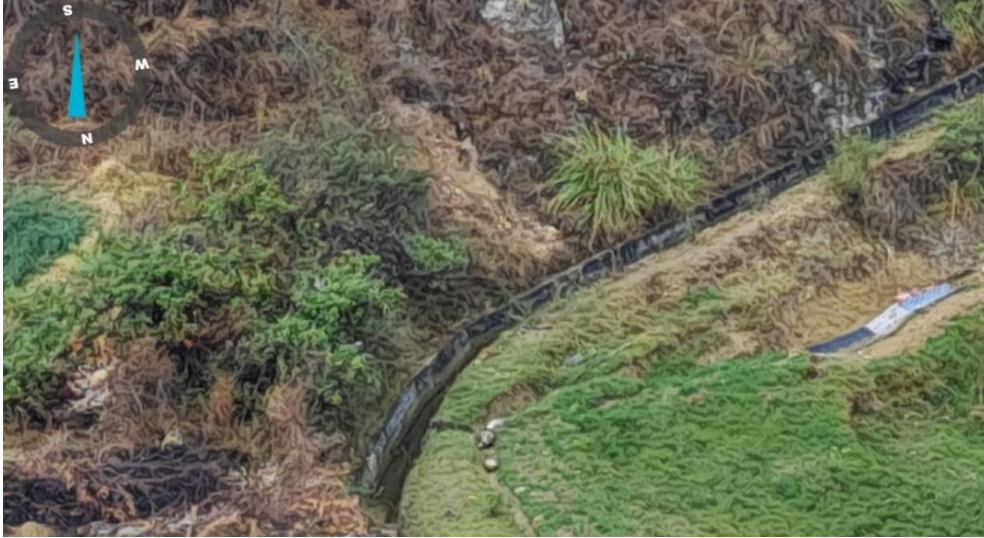
Foto 34. Canal en el área de análisis, cauce artificial realizado por la mano del hombre para transportar el agua para darle diferentes usos uno de ellas el cultivo. (Coordenadas UTM 782784E 9211287N, Orientación de foto 189°S).
