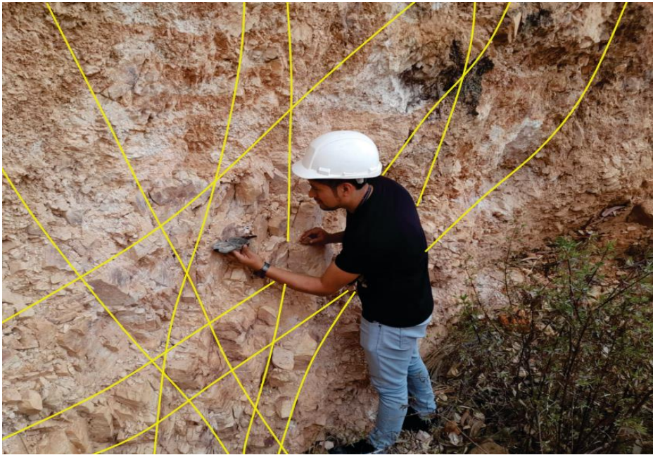
Figura 18: Fracturas medidas en la estación Geomecánica Cruz Blanca EG- 01CB, con coordenadas Este: 775410.75, Norte: 9202742.33, Cota 2954 m.s.n.m
