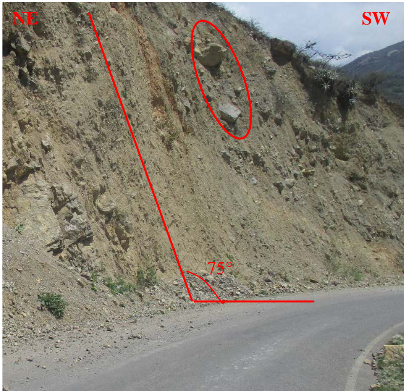
Foto 10. En el km. 1+100 de la carretera que une al C.P. Choropampa con la Asunción, parte baja del C.P. Choropampa, varios bloques de suelo y roca se están desprendiendo del talud.
