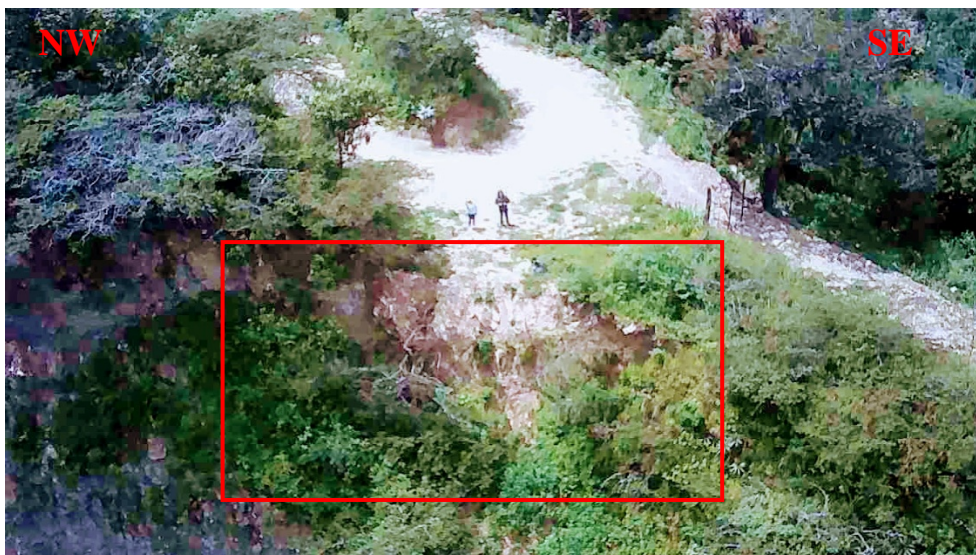
Foto 7. Socavamiento identificado en la carretera al caserío Quivinchan, parte alta del C.P Choropampa, el cual pone en riesgo la transitividad en la carretera.
