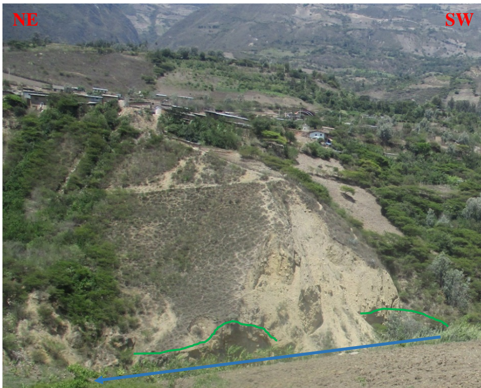
Anexo N° 4. Dirección de flujo (azul), socavamiento (verde), por acción de las aguas del río Magdalena en la parte baja de la C.P Choropamapa.
