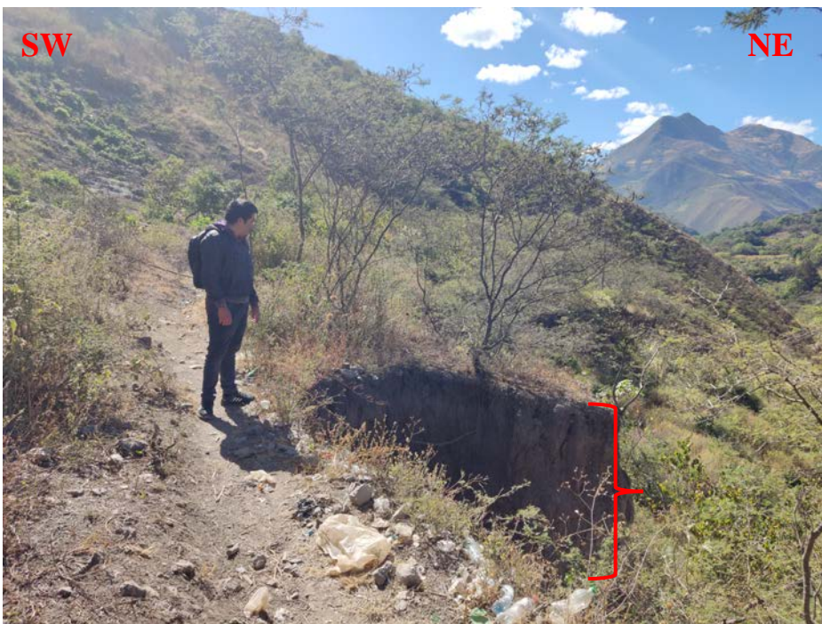
Anexo N° 6. Escarpe de deslizamiento, identificado en la estación N° 06, el cual está siendo ocasionado por la corriente del Río Magdalena metros más abajo.
