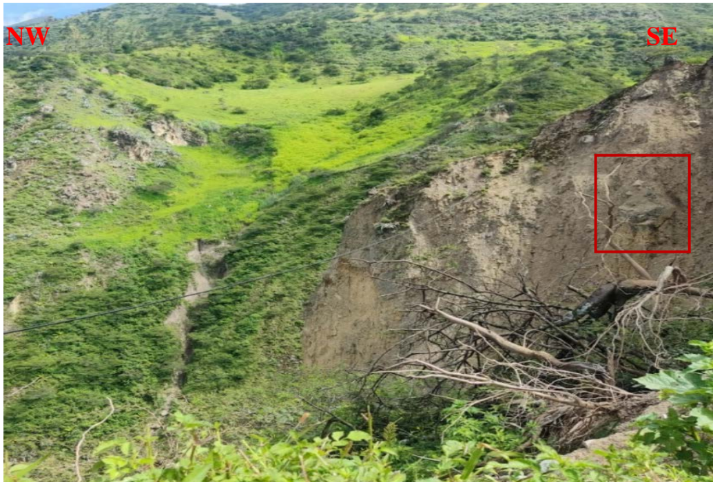
Foto 8. Caída de Rocas identificado en el flanco derecho de la quebrada Llagaden, se observan bloques de roca (rojo) a punto de caer por el talud, debido a la alta pendiente.
