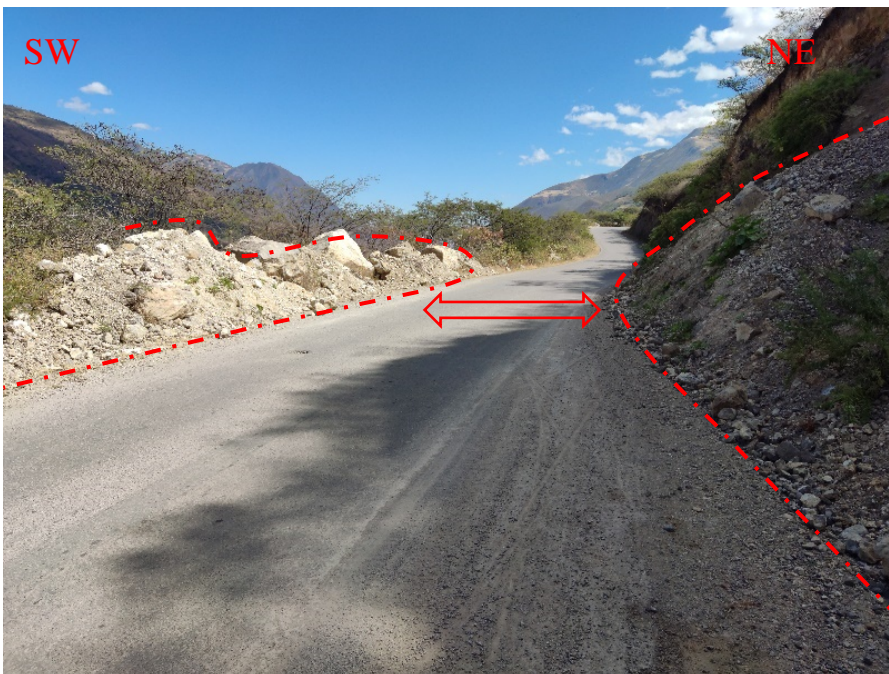
Anexo N° 2. Cuando las lluvias son prolongadas el arrastre de detritos bloquea totalmente la carretera.
