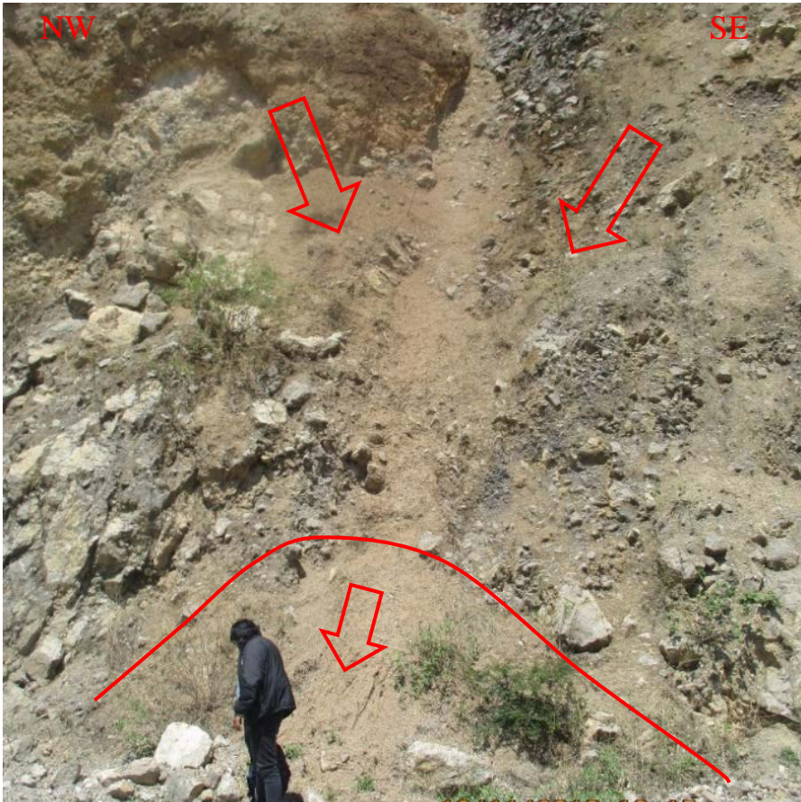
Anexo N° 1. Discurriramiento de las aguas de lluvia con una depositación en el pie de talud en la carretera.
