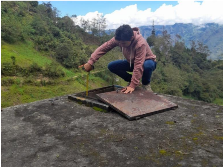
Figura 51: Válvula expuesta al aire libre y sin protección en el Sistema N.º 1
