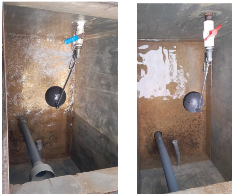
Figura 31: y Figura 32: Vista de la cámara rompe presión N.º 1 y N.º 2 tipo 7 del Sistema N.º 2, respectivamente.
