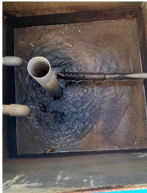
Figura 23: Vista de la cámara húmeda de la cámara de reunión de caudales
