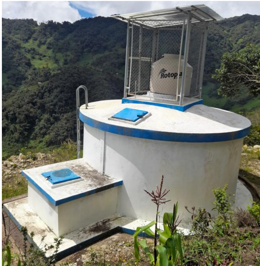
Figura 24: Vista del Reservorio de forma circular del sistema de agua potable N.º 1
