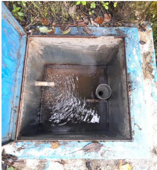
Figura 17: Vista de la cámara húmeda de la captación N.º 1
