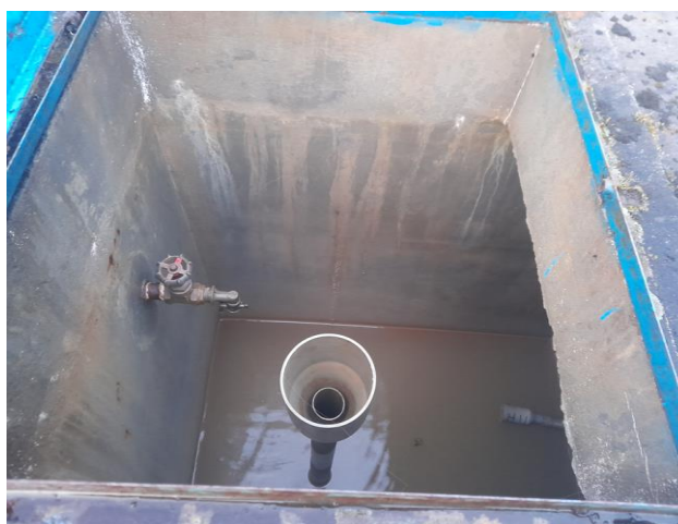
Figura 25: Vista de la cámara rompe presión N.º 2 tipo 7 del sistema N.º 1
