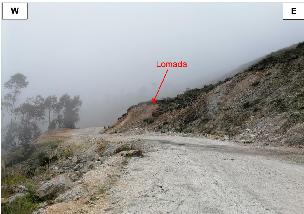
Figura 3.7. Lomadas ubicadas en el flanco derecho en la carretera del centro poblado Yanivilca.
