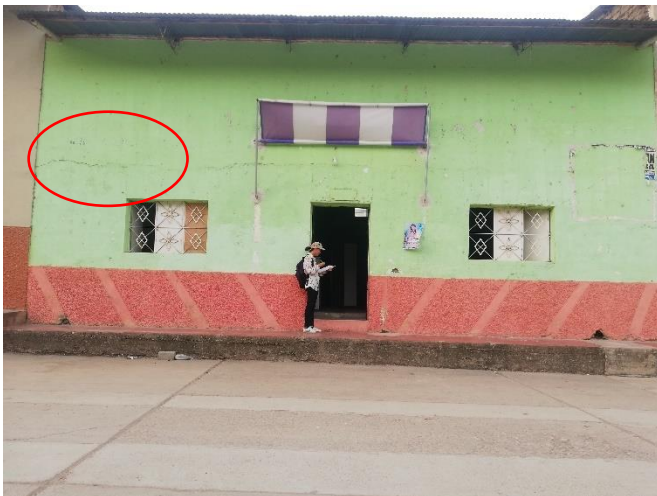
Fachada de vivienda evaluada con fisura horizontal en enlucido de yeso
