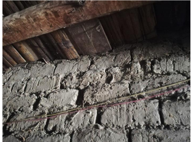
Adobe no homogéneo con mortero de barro discontinuo.
