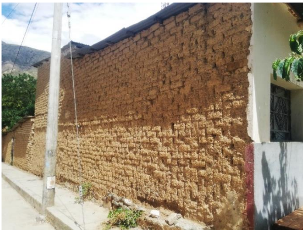
Muro en regular condición por intemperización
