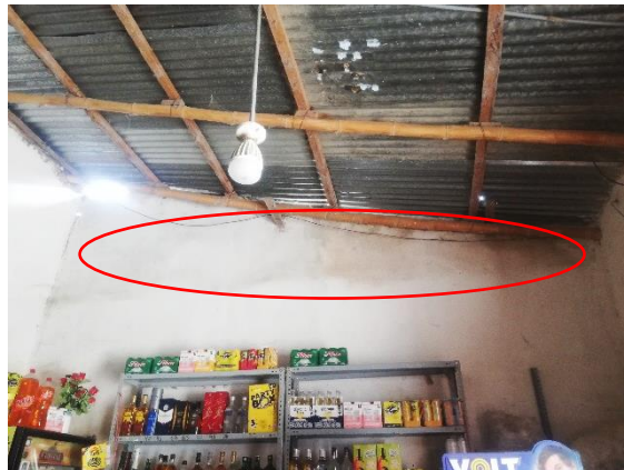
Filtración de agua de lluvia al muro.
