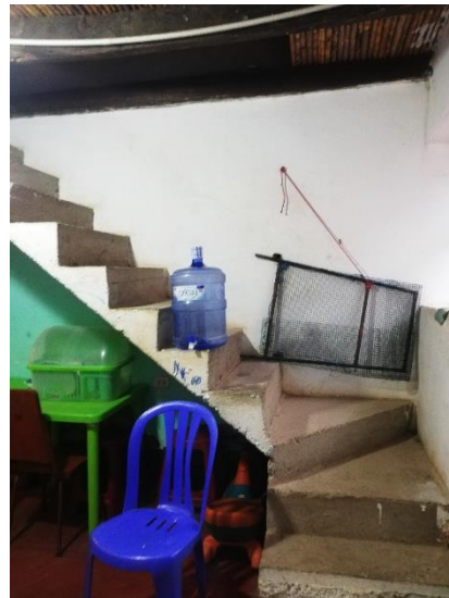
Modificación de escalera de adobe a concreto y presencia de entrepiso de caña brava y vigas de madera que han sido deformadas lateralmente.
