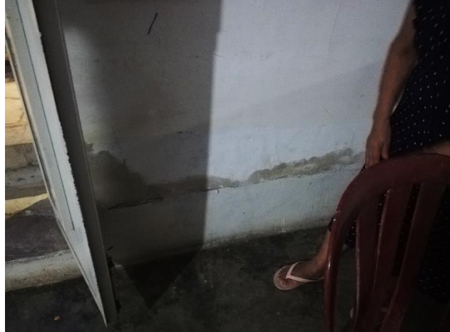
Zona húmeda (muro) sobre el sobrecimiento
