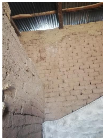
Levantamiento de muro, filtración de agua de lluvia hacia el muro
