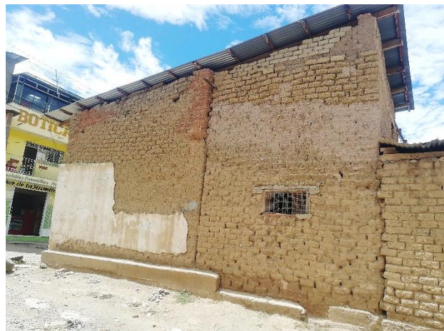
Inadecuado amarre de muros
