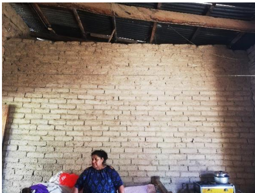
Muro en regular condición
