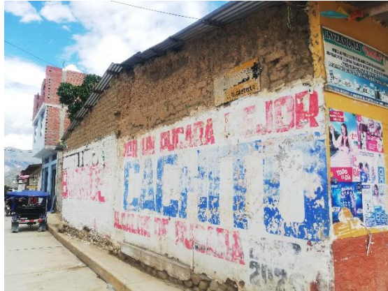
Muro deteriorado y sobrecimiento dañado en la parte baja.
