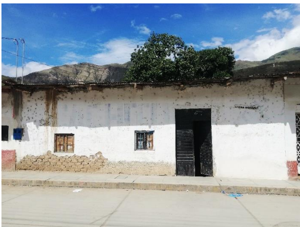
Desprendimiento de enlucido en fachada.
