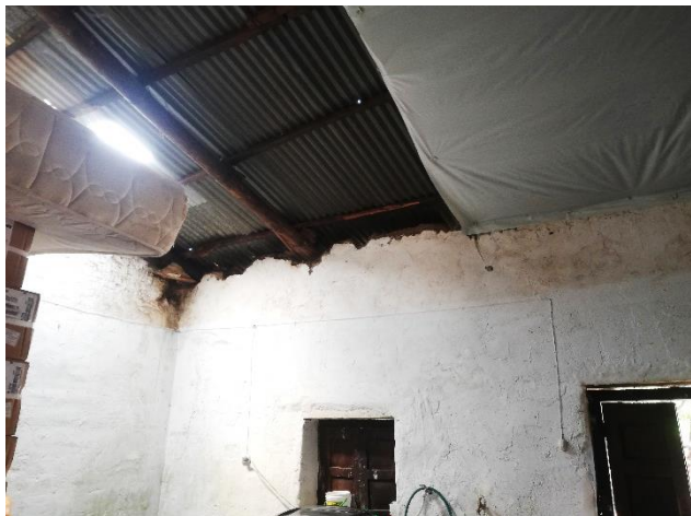
Deterioro de muro ante la filtración del agua de lluvia.
