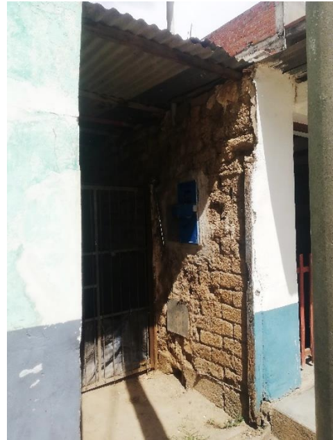
Muro en regular condición por intemperización
