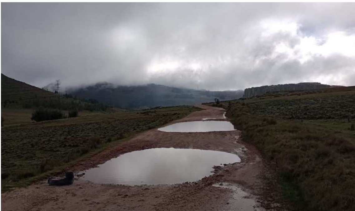
Figura N° 9: Situación actual de la carretera Cajamarca - Chetilla. Altura del Bosque de Piedras de Sexemayo
