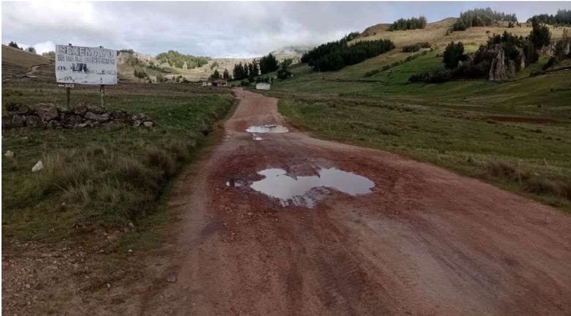
Figura N° 10: Situación actual de la carretera Cajamarca - Chetilla. Punto inicial del tramo en estudio.
