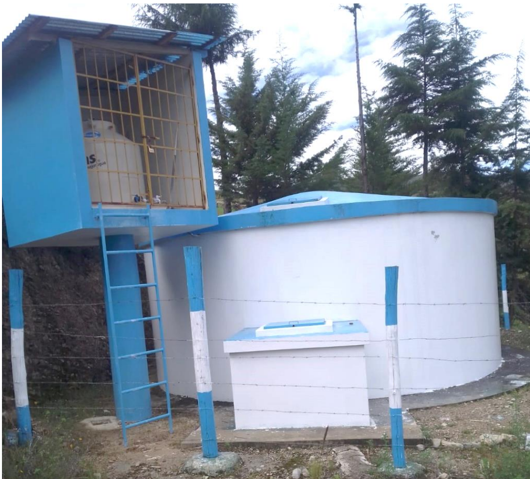
Figura 34 Captación El Naranjillo.
