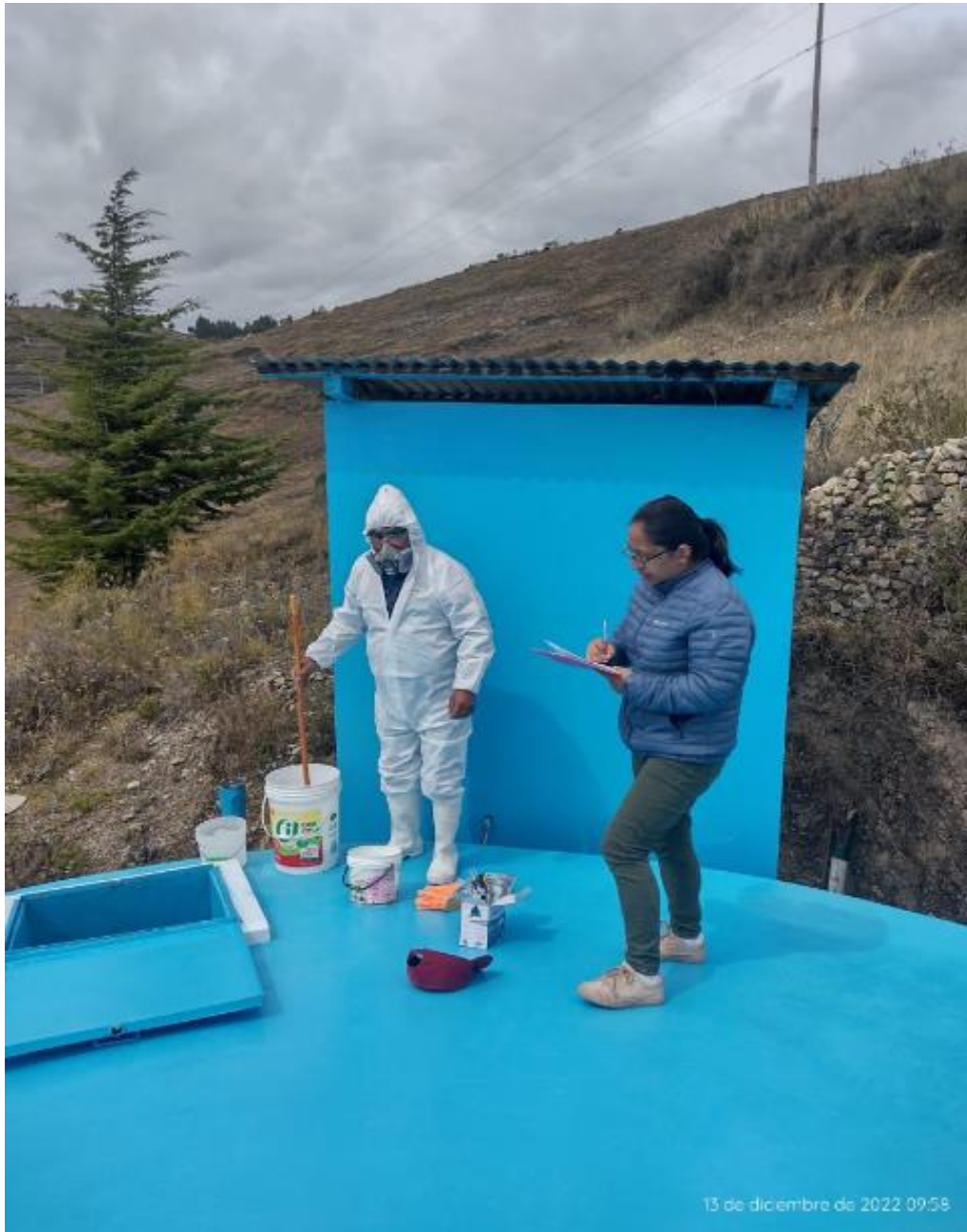
Figura 49 Cloración de reservorio El Naranjillo.
