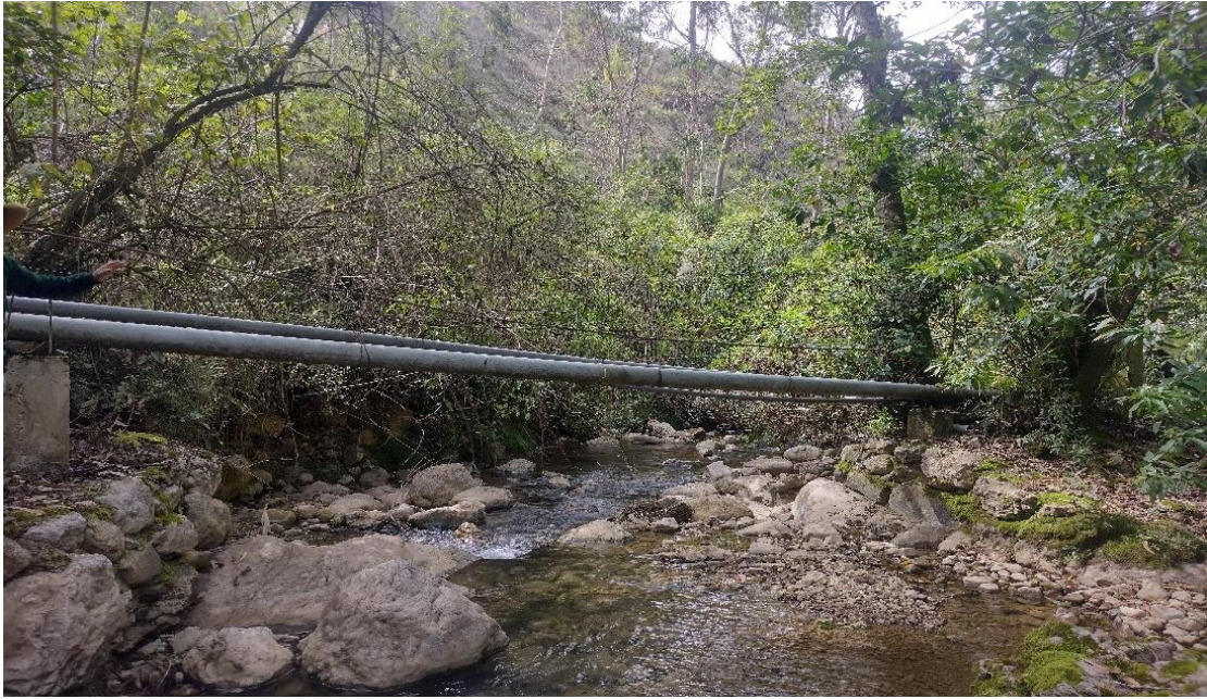
Figura 32 Pase aéreo en línea de conducción el Naranjillo.
