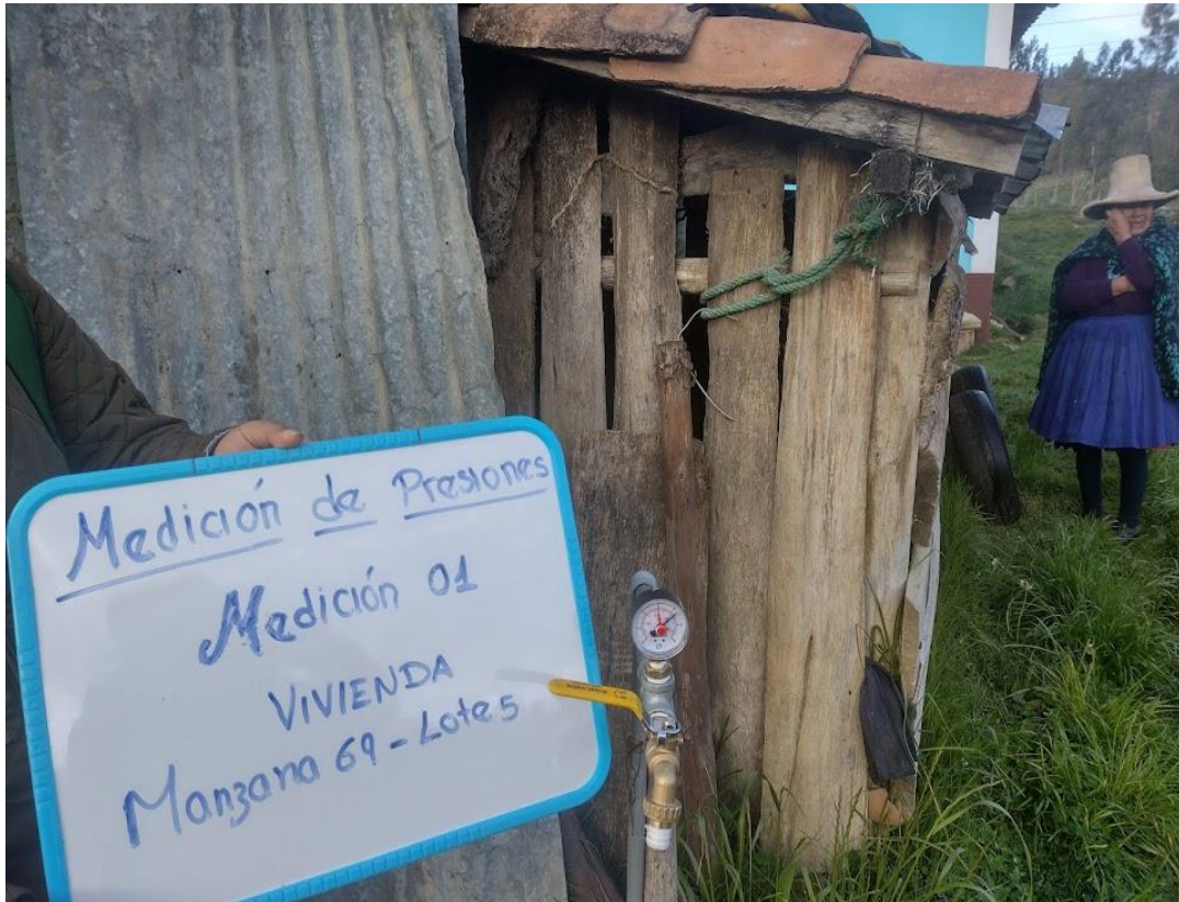
Figura 22 Medición de presiones en el sistema de agua potable de Juancho Puquio.
