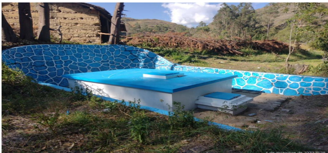
Figura 29 Captación Juancho Puquio- Falta de cerco perimétrico.
