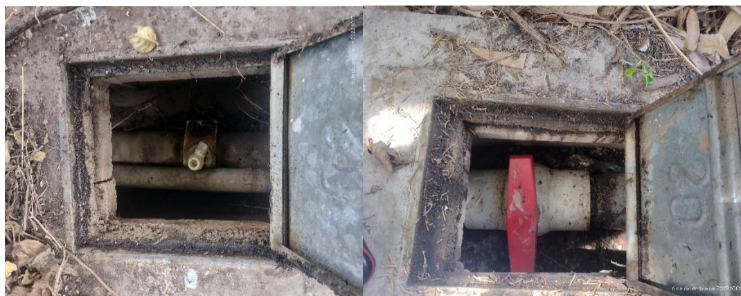
Figura 31 Válvula de aire y válvula de purga en línea de conducción el Naranjillo.
