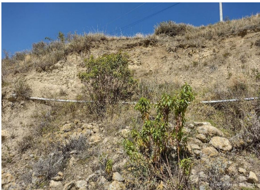
Figura 35 Tubería expuesta en línea de aducción el Naranjillo.
