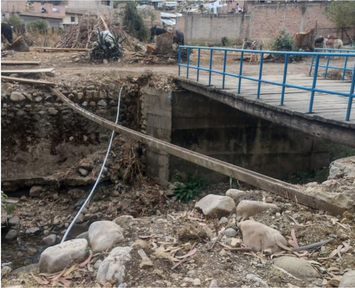
Figura 36 Tubería expuesta en la red de distribución Juancho Puquio.
