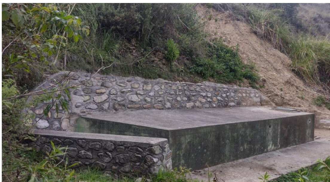
Figura 30 Captación El Naranjillo- Falta de mantenimiento y cerco perimétrico.
