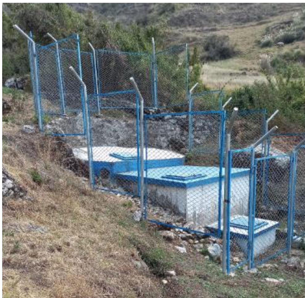
Captación la Shita
