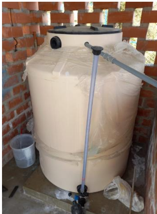
Interior de la caseta de cloración de R2
