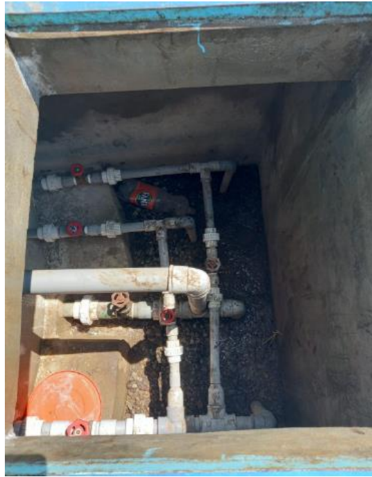
Caja de válvulas de R2
