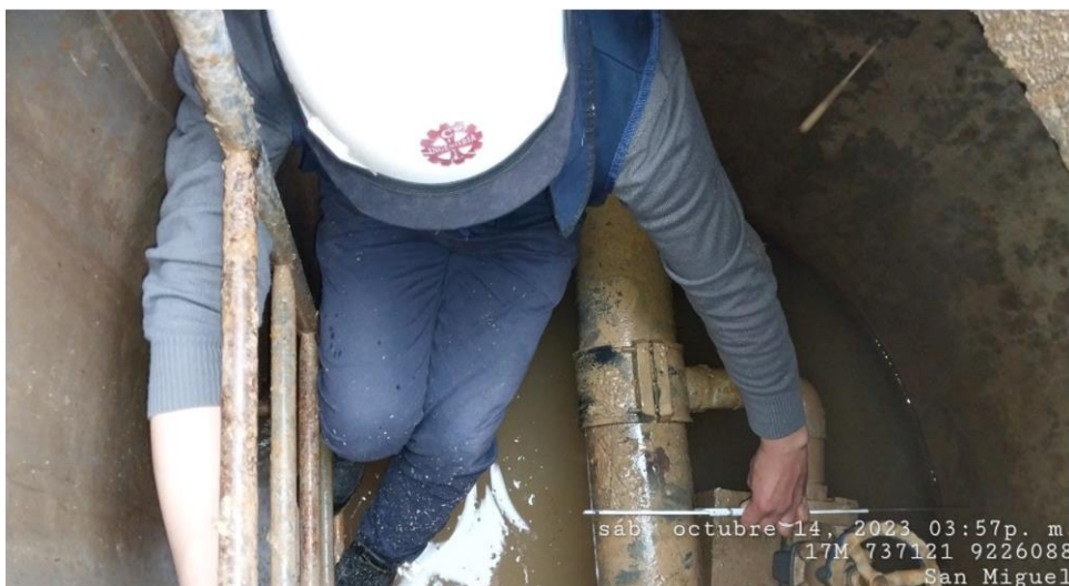
Figura 45: Línea de conducción del SAP San Miguel
