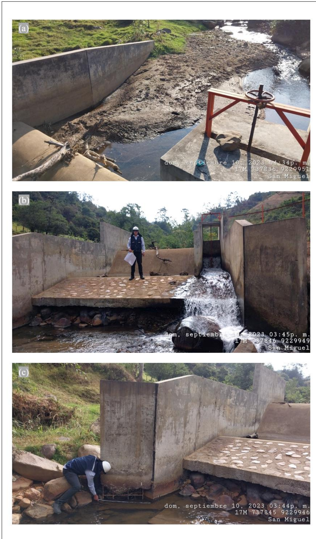
Figura 99: Bocatoma del SAP San Miguel (02/02)
