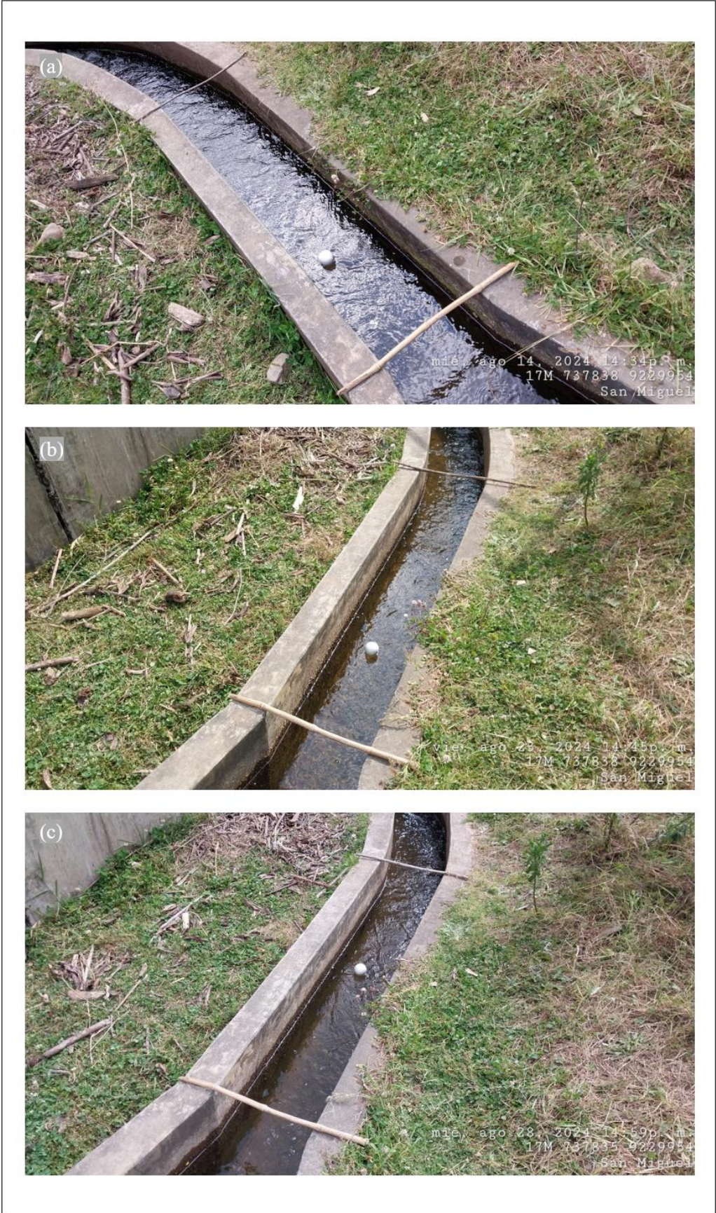
Figura 114: Aforo del caudal derivado por el SAP San Miguel
