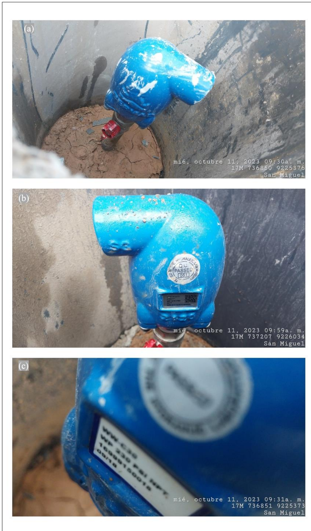
Figura 108: Válvulas de aire de la red de distribución del SAP San Miguel
