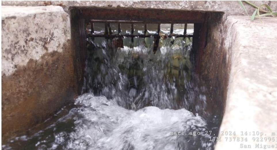
Figura 52: Ventana de captación, bocatoma del SAP San Miguel
