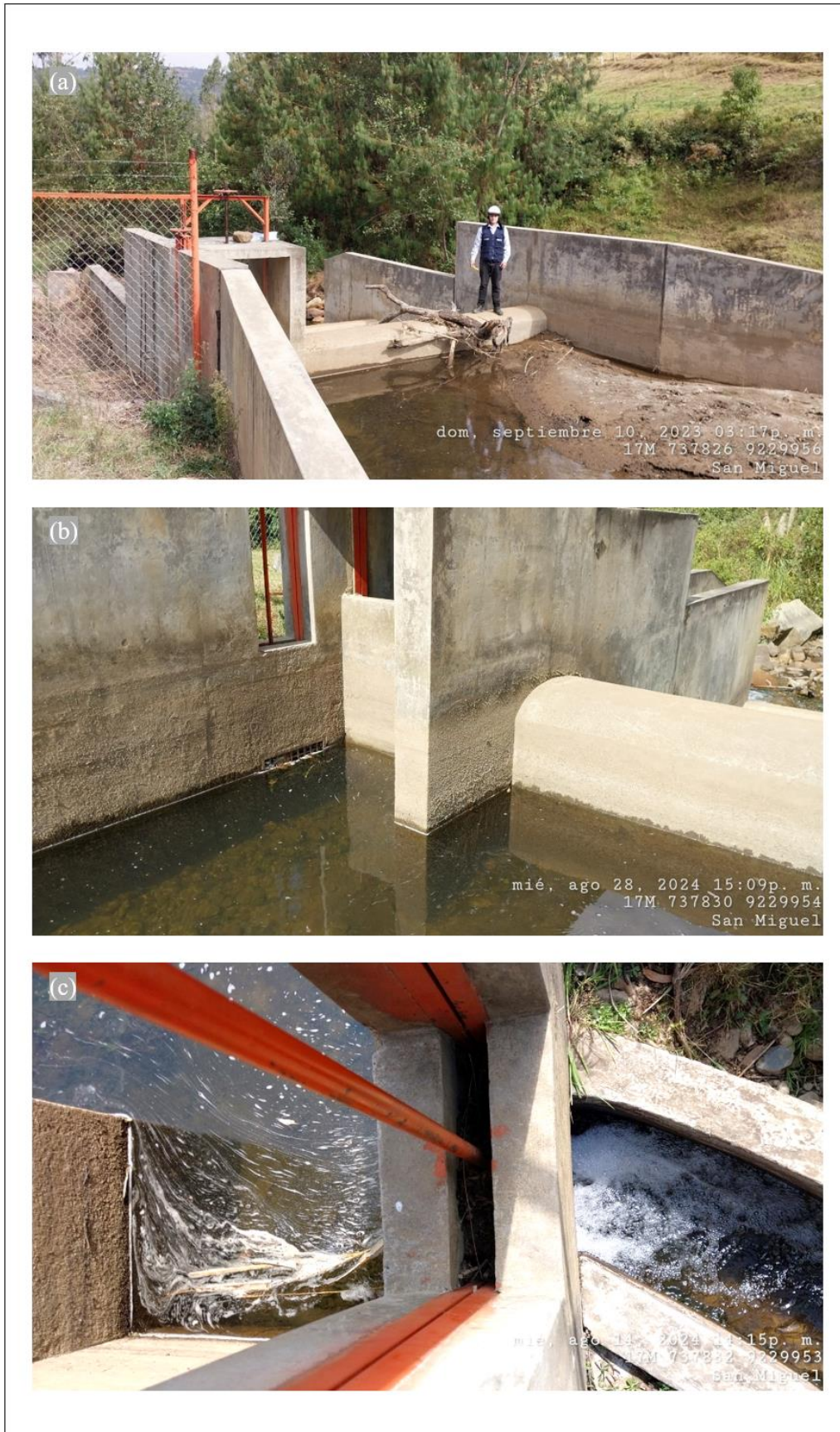
Figura 98: Bocatoma del SAP San Miguel (01/02)
