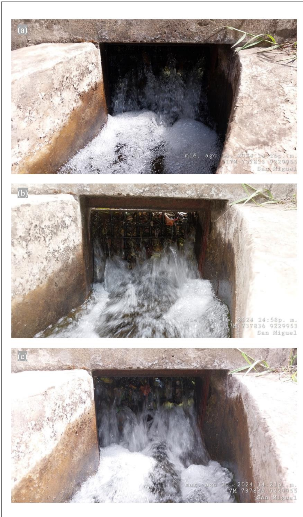
Figura 113: Tirante de agua en la ventana de captación, bocatoma del SAP San Miguel
