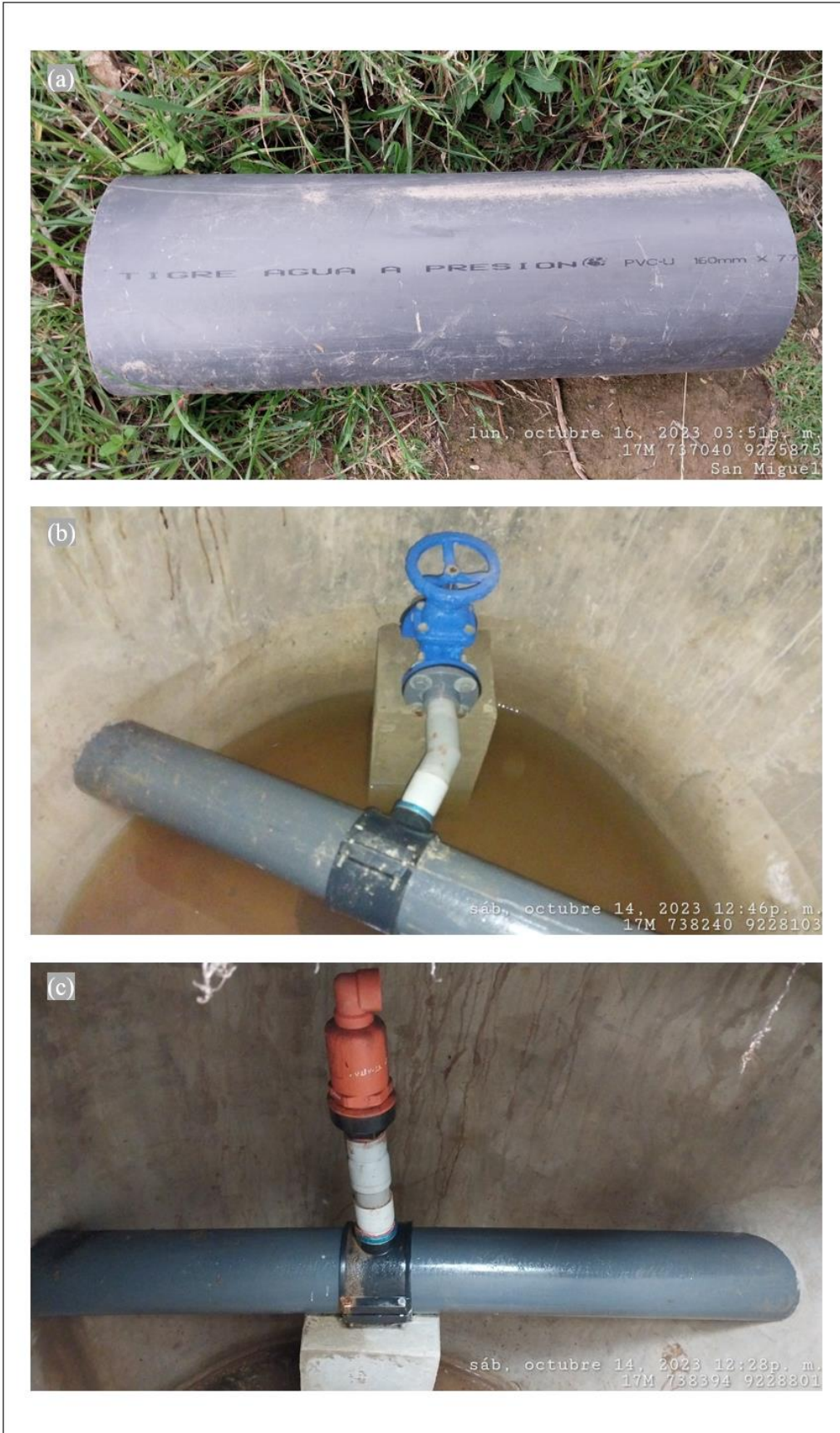
Figura 103: Línea de conducción del SAP San Miguel (02/02)
