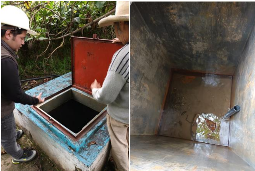
Figura 19. Inspección técnica en la captación de Santa Rosa: perspectivas interna y externa junto al operario del sistema de agua potable. Coordenadas UTM: Zona 17M, 817791.00 mE, 9238933.00 mN
