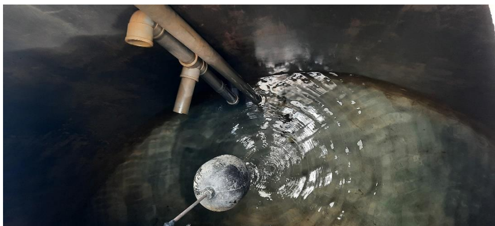
Figura 68. Nivel del agua a las 11 a.m.: Casi agotado, indicando un abastecimiento discontinuo
