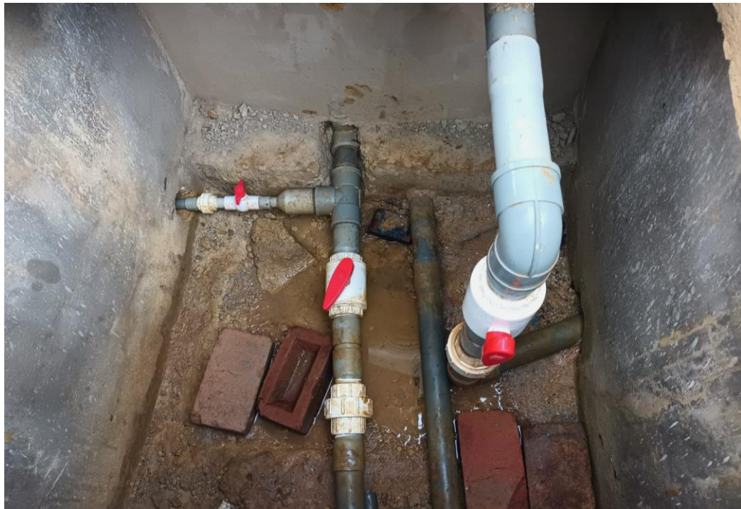
Figura 58. Vista Interna y Evaluación Técnica de la Cámara de Válvulas del Reservorio.
