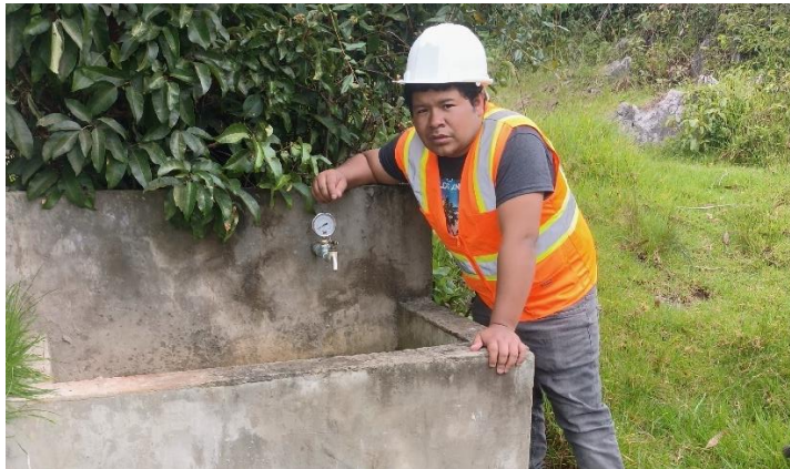
Figura 70. Inspección y toma de datos de las presiones en los manómetros instalados
