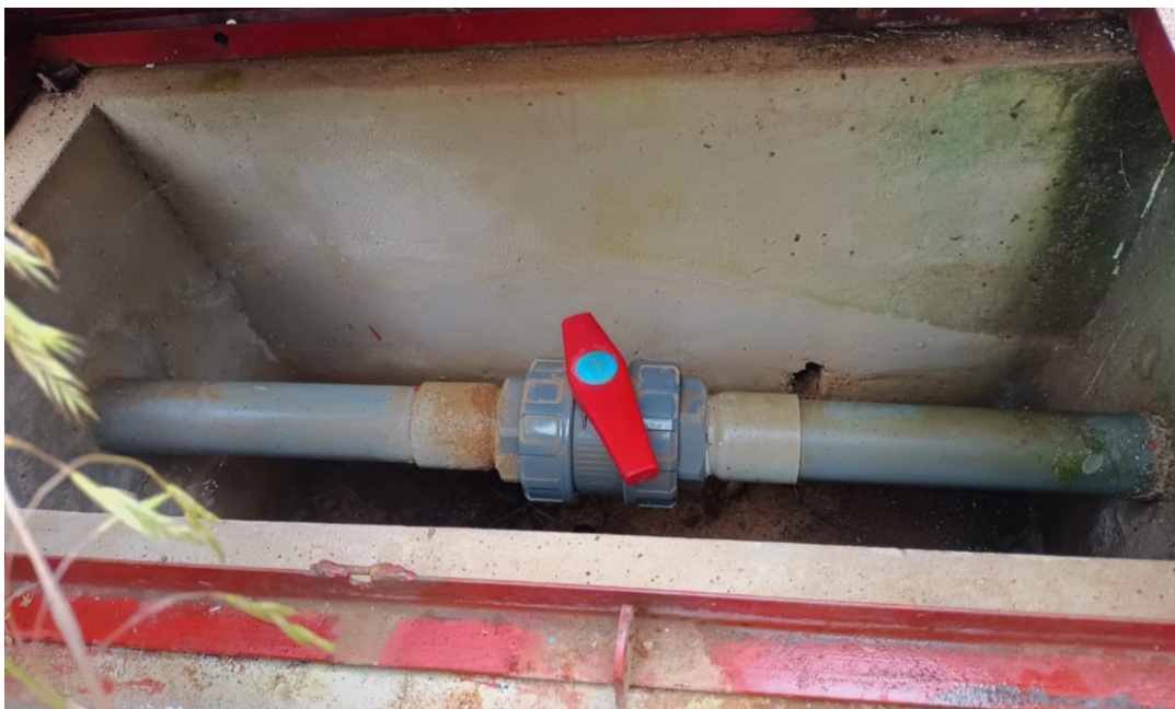
Figura 63. Evaluación visual del estado actual de la válvula en la cámara seca de la CRP-T7. Coordenadas UTM: Zona 17M, 817,330.94 mE, 9,239,321.02mN
