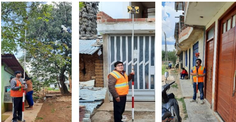
Figura 51. Día 4 del levantamiento topográfico- toma de puntos de redes de distribución y conexiones domiciliarias.
