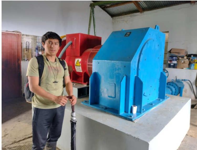
Figura N° 68: Reconocimiento de instalaciones de la mini central hidroeléctrica - sala de máquinas.
