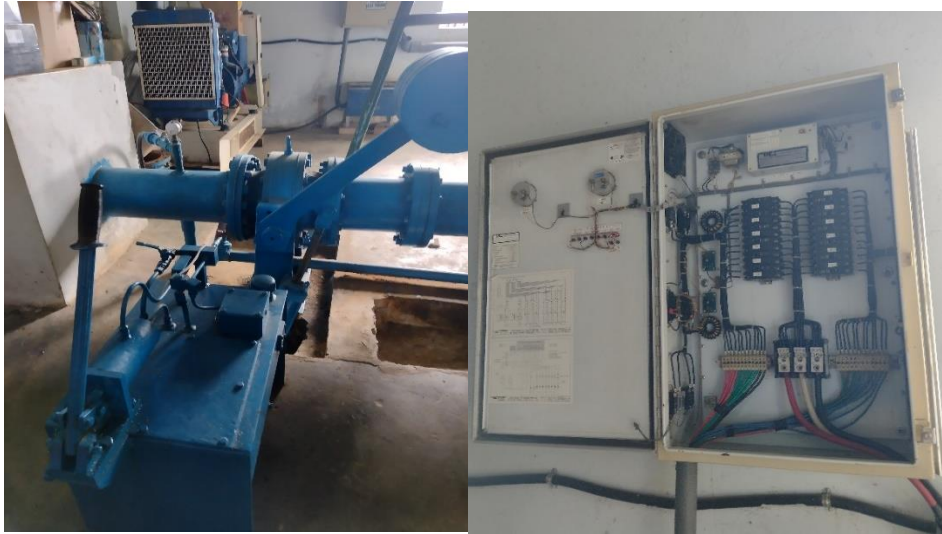
Figura N° 26: Alternador de corriente y estabilizador de 80Kw A 220v, con tablero de distribución.
