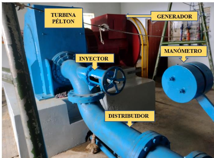
Figura N° 25: Turbina tipo Pelton con principales componentes de ingreso en cámara de fuerza de la MCH.
