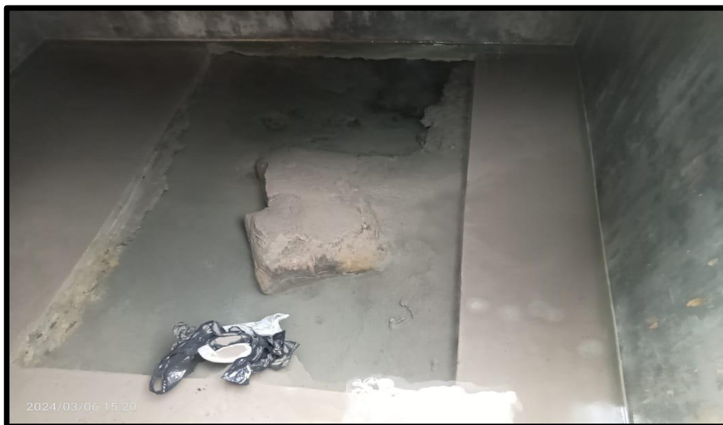
Figura14: Cámara húmeda - captación agua blanca
