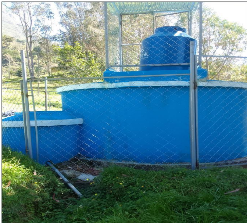
Figura 8: reservorio y tanque de cloración
