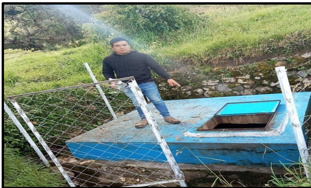
Figura 13: Captación de fondo –denominada “Agua blanca”
