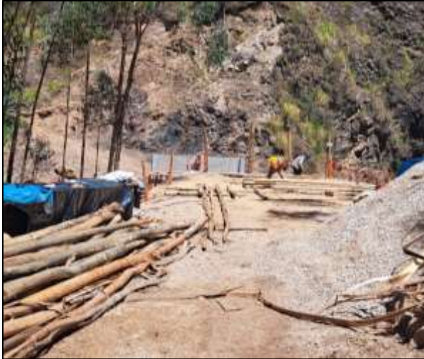
Figura 7 Zona sin señalización de riesgos
