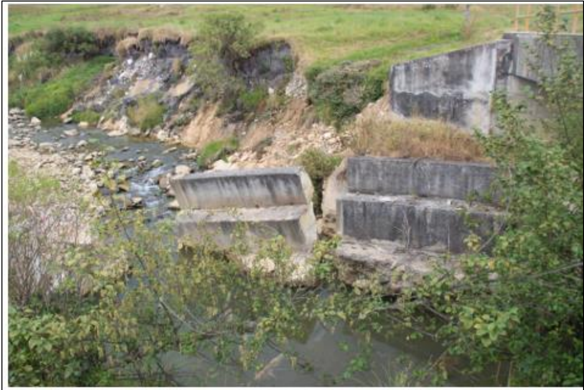
Figura 26 : Colapso de muros laterales en puente existente en la zona de estudio.
