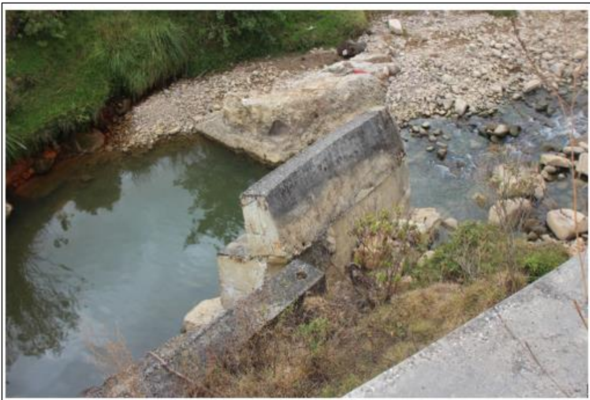
Figura 25 : Colapso de un puente por una máxima avenida.
