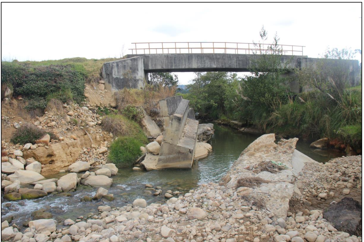
Figura 23 : Daños ocasionados a un puente del río la Quispa.
