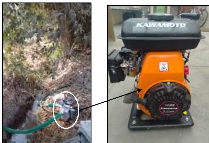
Figura 17. Abastecimiento de agua de canal de riego aledaño usando motobomba de 1,5 hP.
