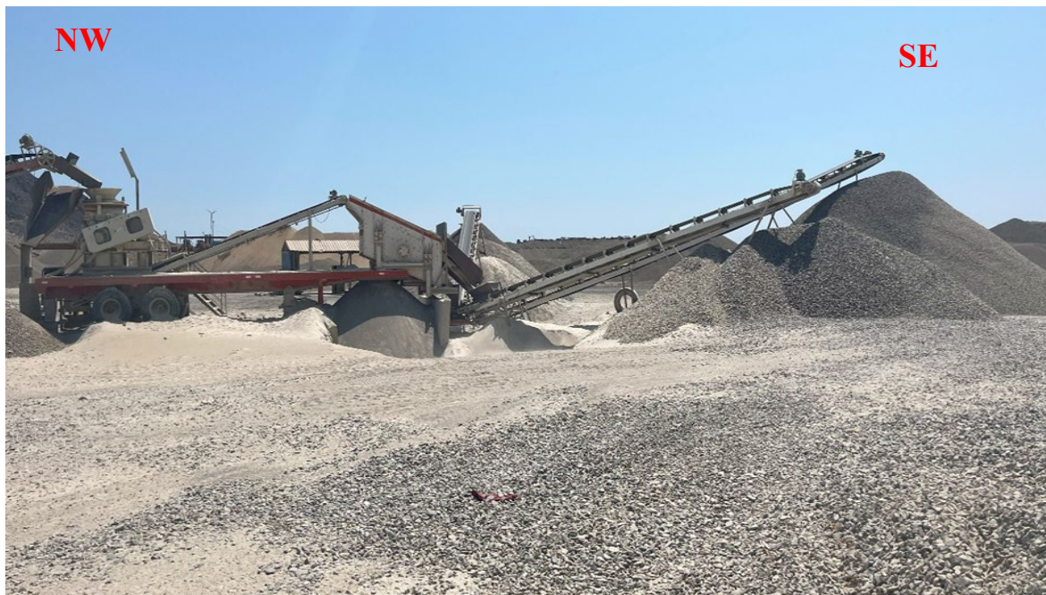
Foto 10: Planta procesadora de chancado primario y secundario
