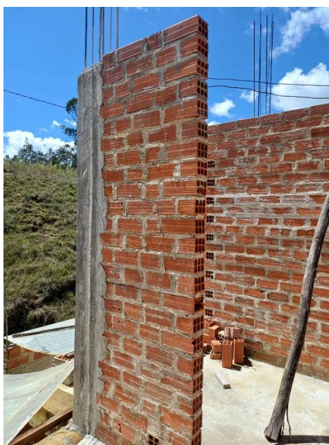
Figura 18. Muro de Ladrillo - Vivienda 05
