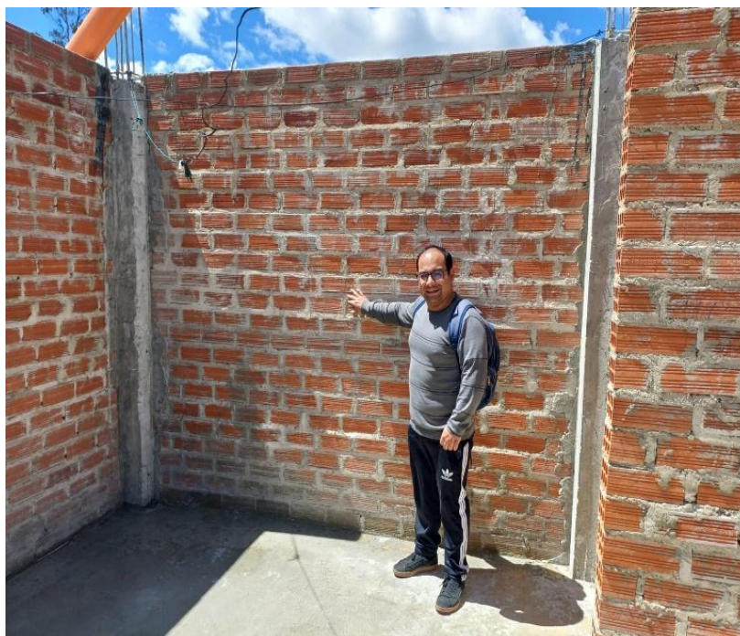
Figura 17. Muro de ladrillo - Vivienda 05
