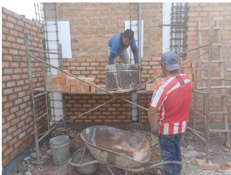
Figura 12. Muro de Ladrillo Vivienda 02
