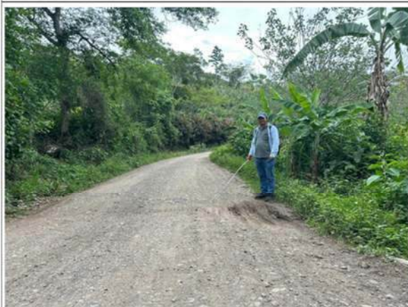
Foto 31: Baches en plataforma en plataforma - KM 6+700
