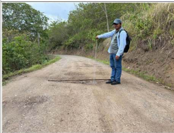
Foto 25: Baches en plataforma - KM 5+280
