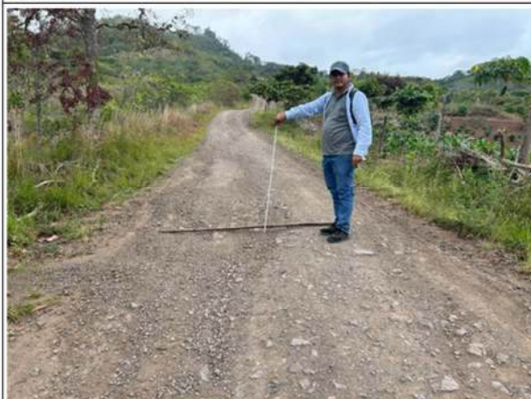
Foto 36: Erosión en plataforma en plataforma - KM 8+490
