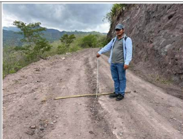
Foto 26: Erosión en plataforma - KM 5+430
