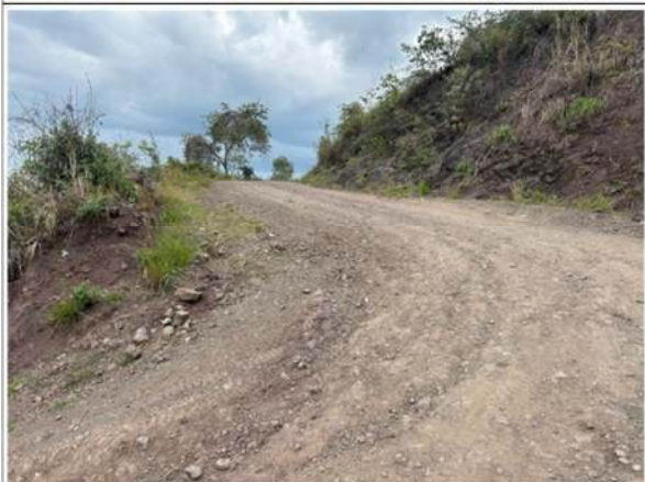
Foto 35: Erosión en plataforma en plataforma - KM 8+090
