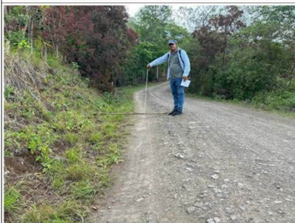
Foto 28: Deformación en plataforma - KM 6+110
