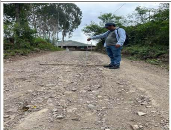
Foto 29: Erosión en plataforma en plataforma - KM 6+200
