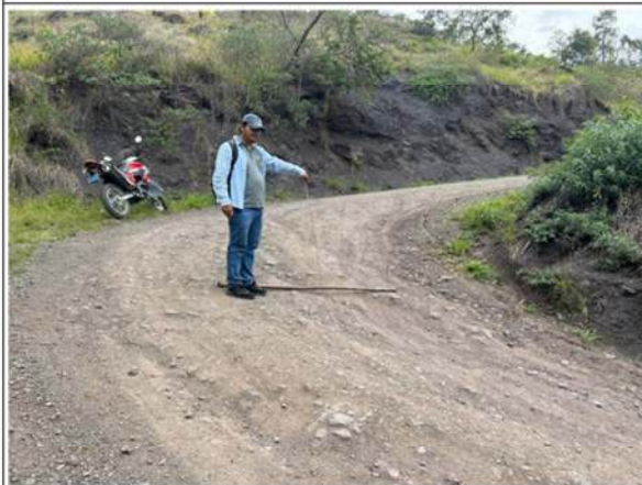
Foto 34: Erosión en plataforma en plataforma - KM 7+920
