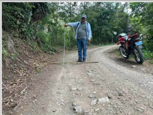
Foto 33: Erosión en plataforma en plataforma - KM 7+560
