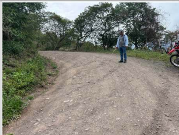
Foto 32: Erosión en plataforma en plataforma - KM 7+410
