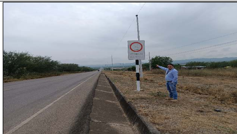
Foto N°06. Señal R-30. Ilegible en mal estado de conservación
