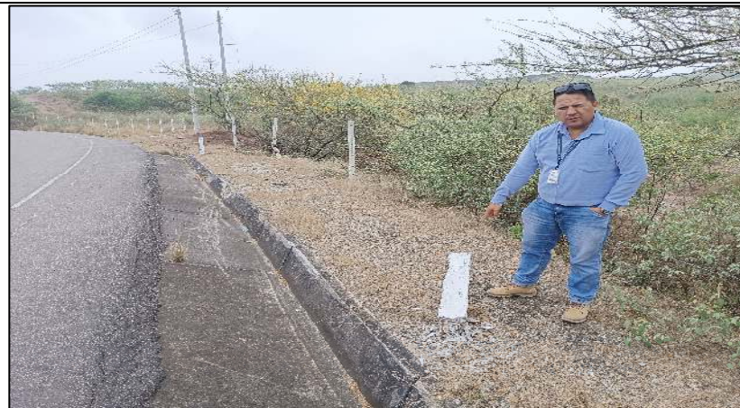
Foto N°18. Dispositivo de Seguridad en mal estado de conservación
