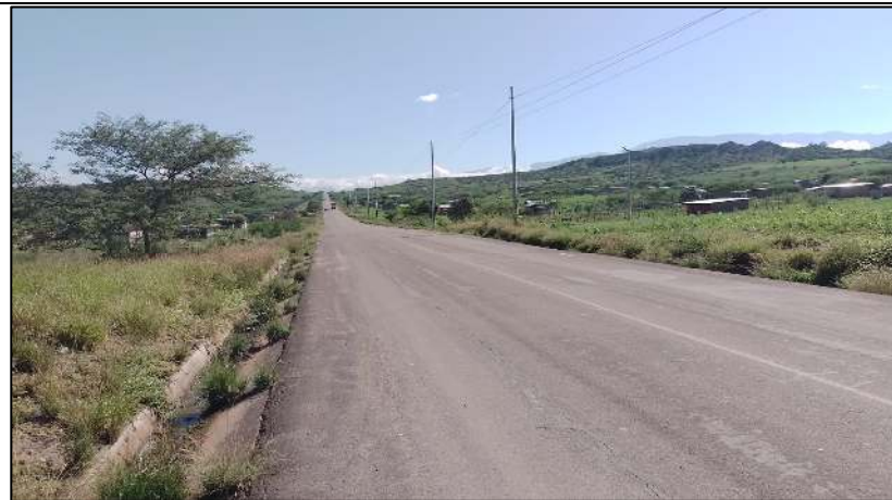
Foto N°14. Ausencia de Marcas en el Pavimento (Lateral y Central) denota mal estado de conservación
