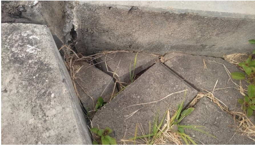
Figura 97 Depresiones en estacionamiento 2A
