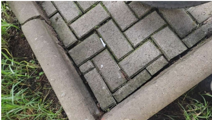
Figura 88 Levantamiento o empuje en estacionamiento 1A
