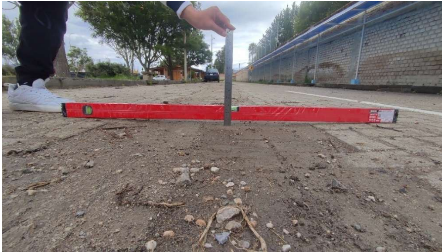
Figura 115 Ahuellamiento en Av. Mario Alzamora Valdez
