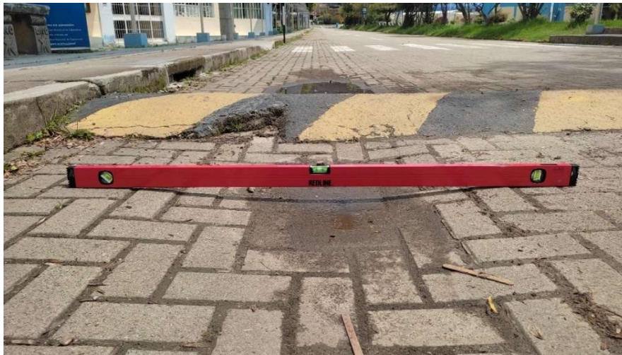
Figura 112 Ahuellamiento en Av. Servicios
