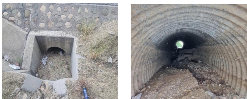
Alcantarilla TMC de 36"
