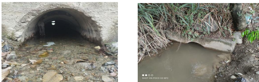
Alcantarilla TMC de 36”
