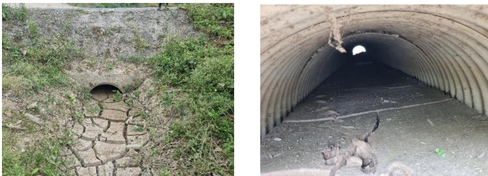
Alcantarilla TMC de 36”
