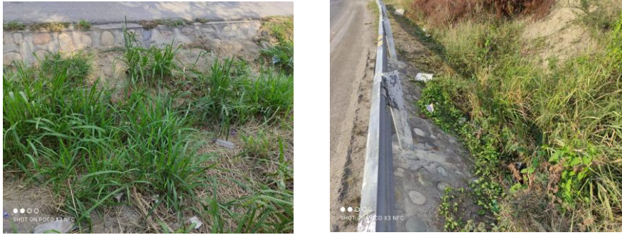
Alcantarilla TMC de 36”
