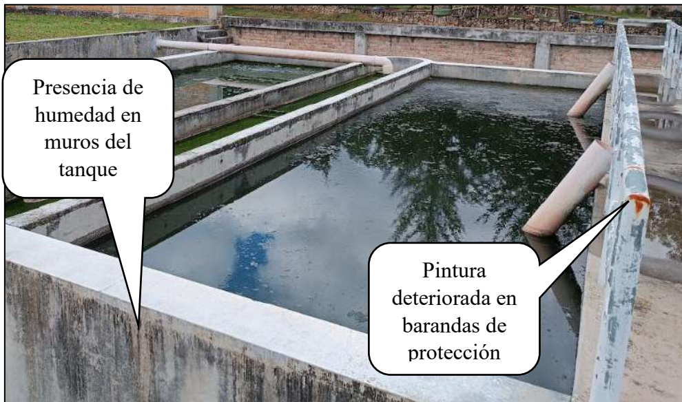
Figura 20: Daños en el Tanque Imhoff N°2
