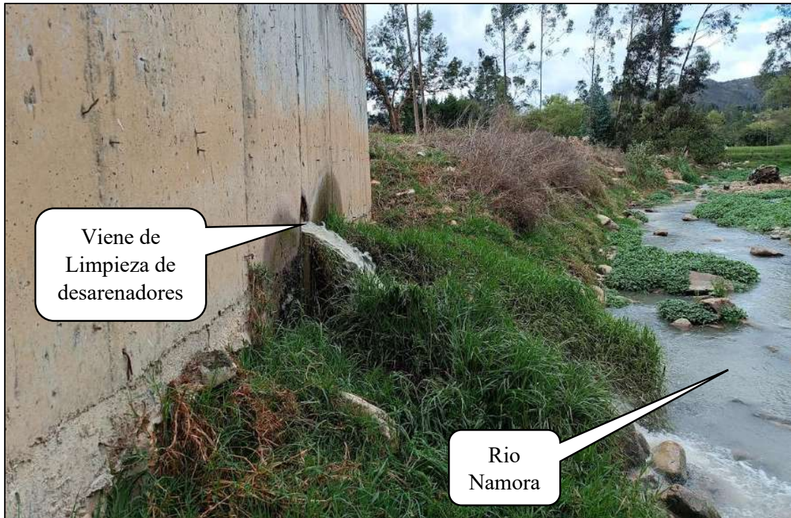
Figura 14: Desfogue de limpia de desarenadores
