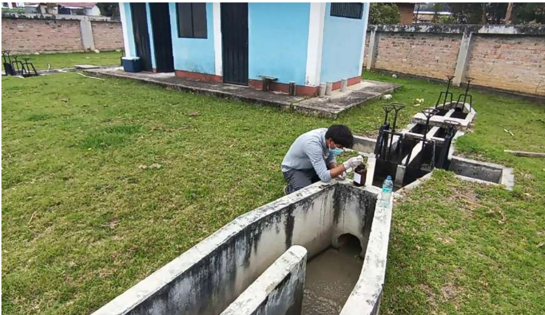
Fotografía N°4. Toma de muestras a la salida del desarenador N°2, fecha 23 de octubre del 2024.
