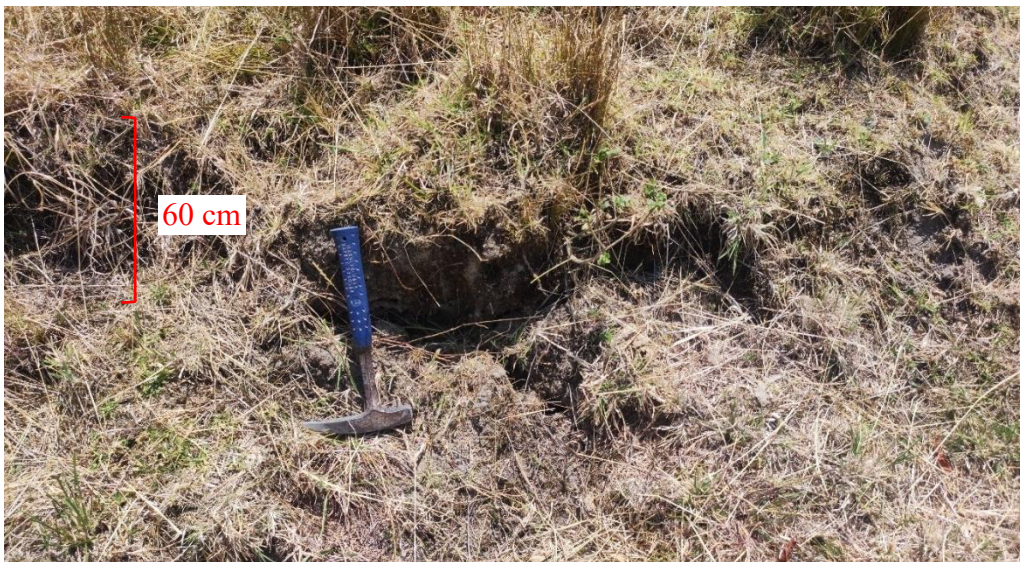
Foto 25: Escarpa del deslizamiento con altura de 60 cm., orientación de foto de W – E. Coordenadas UTM: N: 9215300 – E: 785690 – C: 3082 m.s.n.m.
