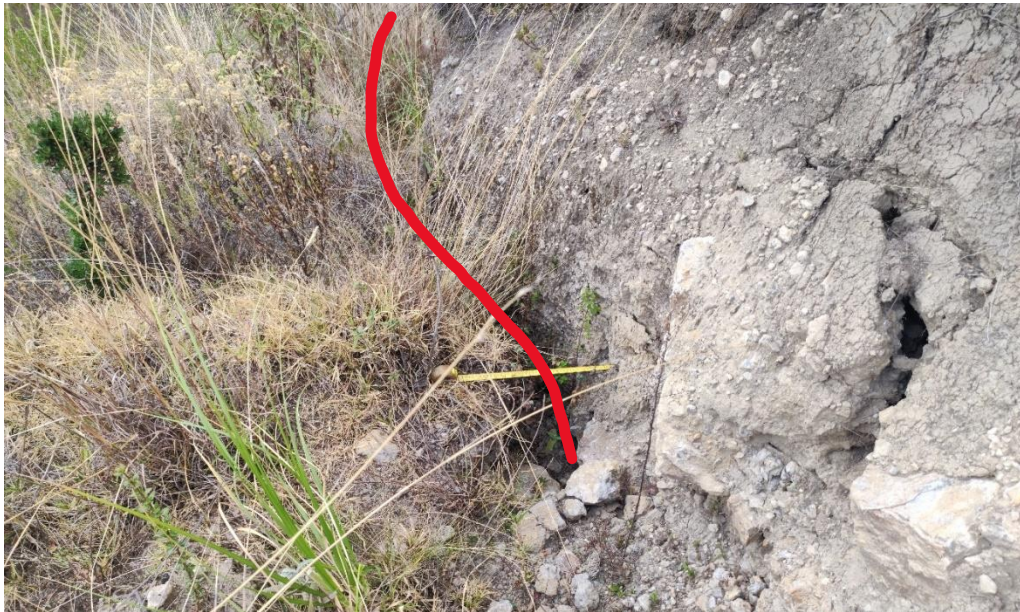
Foto 40: Grieta entre la zona superior y la escarpa, orientación de foto de SW – NE.
