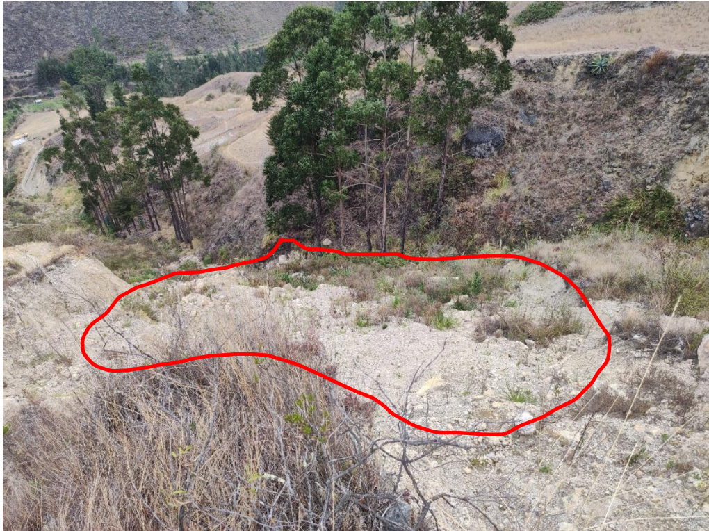
Foto 42: Masa deslizada cubriendo parte de la quebrada, orientación de foto de E – W. Coordenadas UTM: N: 9214913 – E: 785633 – C: 2965 m.s.n.m.
