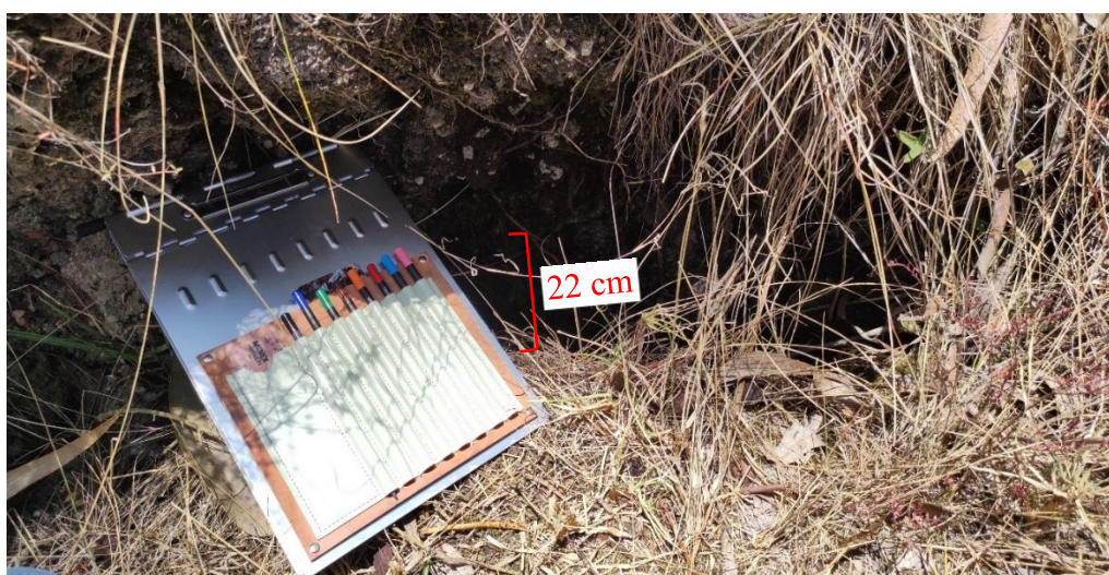
Foto 27: Grieta con un espaciamiento de 0.22 metros, orientación de foto de W – E.
