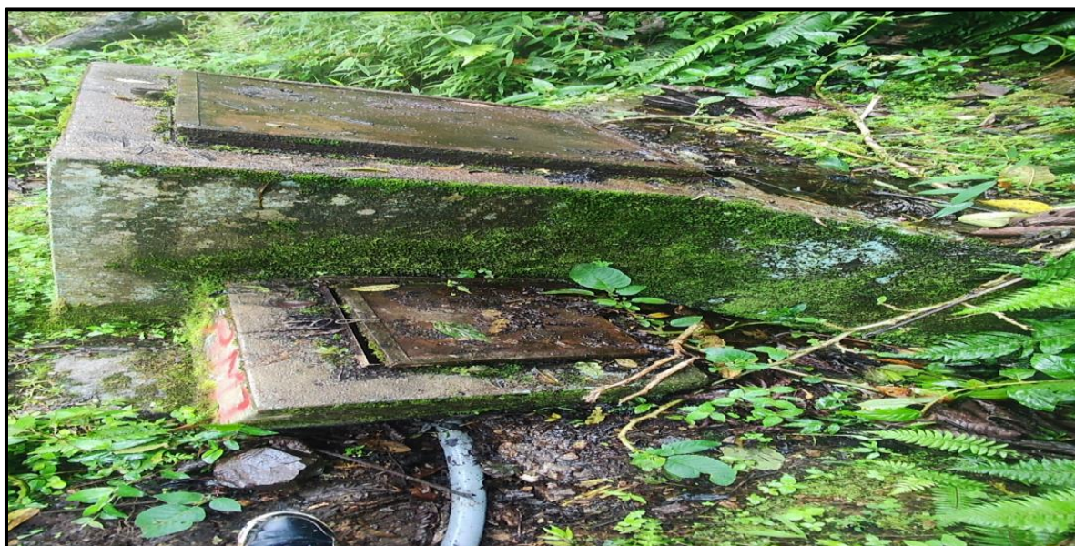
Figura 26: CAPTACIÓN DE LADERA
