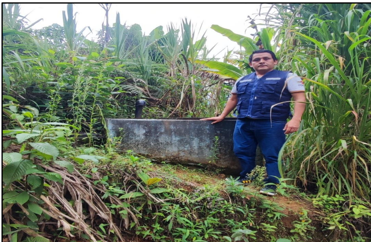
Figura 24: CÁMARA ROMPE PRESIÓN EXISTENTE
