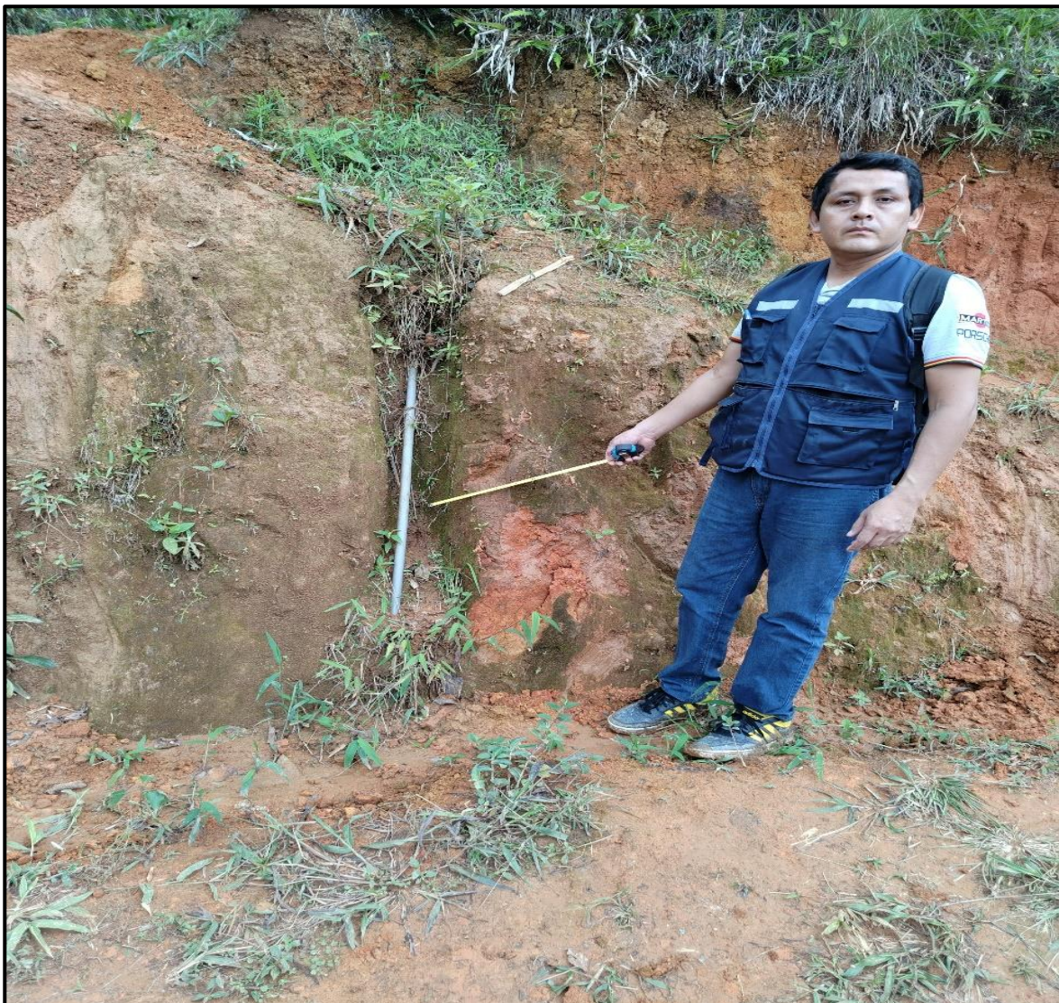
Figura 25: LÍNEA DE DISTRIBUCIÓN EXPUESTA
