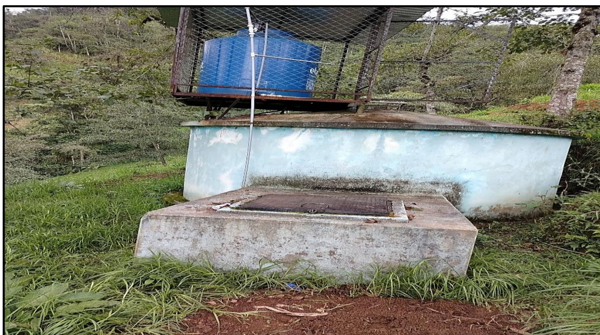
Figura 28: RESERVORIO DE 15 M3
