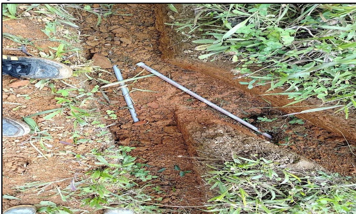
Figura 30: RED DE DISTRIBUCIÓN EXPUESTA
