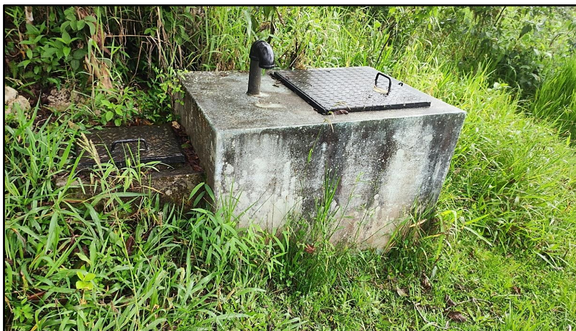
Figura 29: CÁMARA ROMPE PRESIÓN
