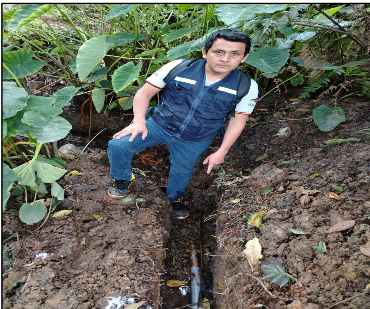
Figura 22: LÍNEA DE CONDUCCIÓN EXPUESTA
