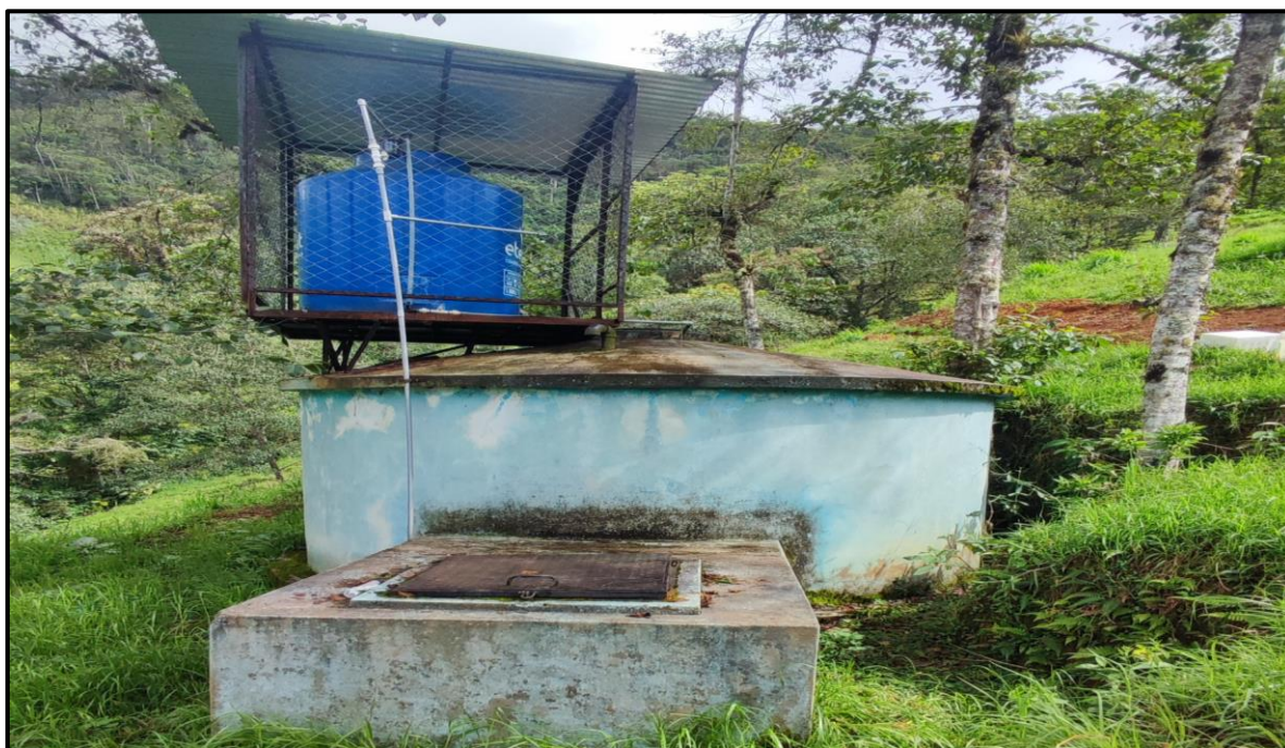
Figura 23: RESERVORIO Y SU DEFICIENTE MANTENIMIENTO
