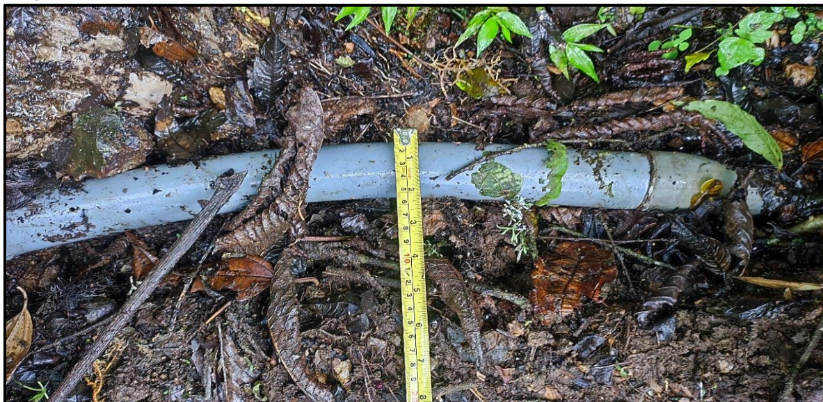
Figura 27: LÍNEA DE CONDUCCIÓN EXPUESTA
