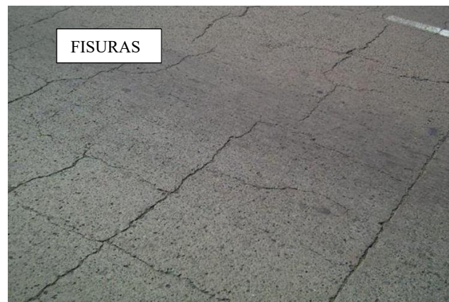
Figura 3. Fisuras en losas de edificaciones
