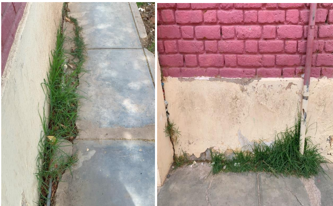
Figura 17. Inspección de Patologías en la vereda de acceso a la Institución R.L.G.
