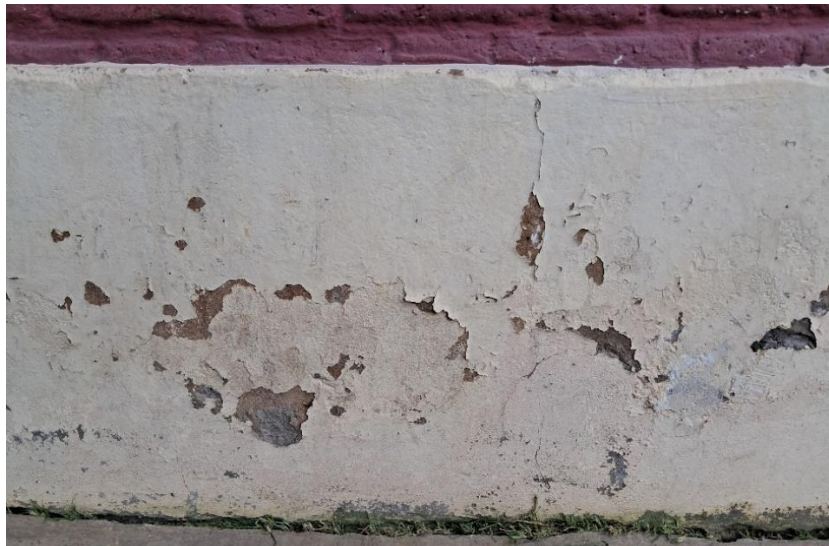
Figura 20. Erosión física y descascaramiento de pintura en el muro de la I.E.R.L.G.
