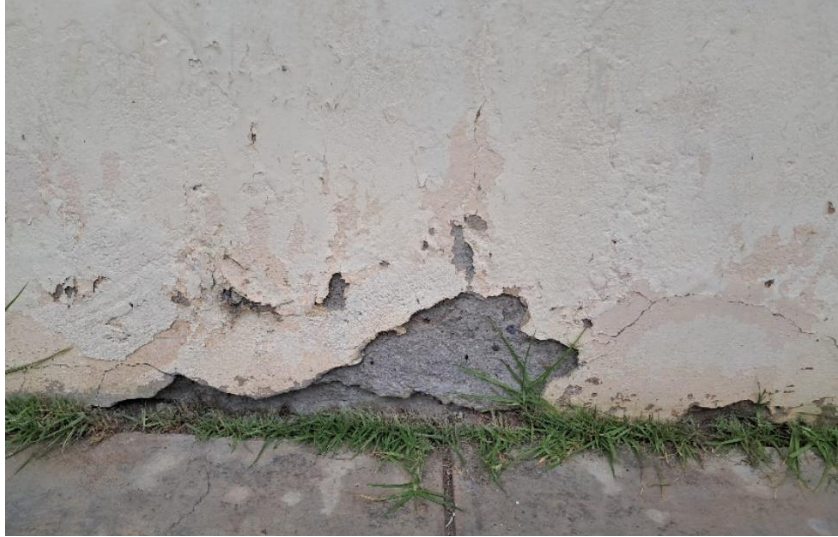
Figura 23. Desprendimiento de acabados en el sόcalo de la I.E.R.L.G.
