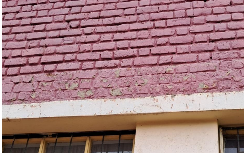
Figura 19. Erosión física y descascaramiento de pintura en el muro de la I.E.R.L.G.
