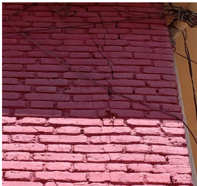
Figura 15. Inspección de fisuras en el muro de la Institución Educativa R.L.G.
