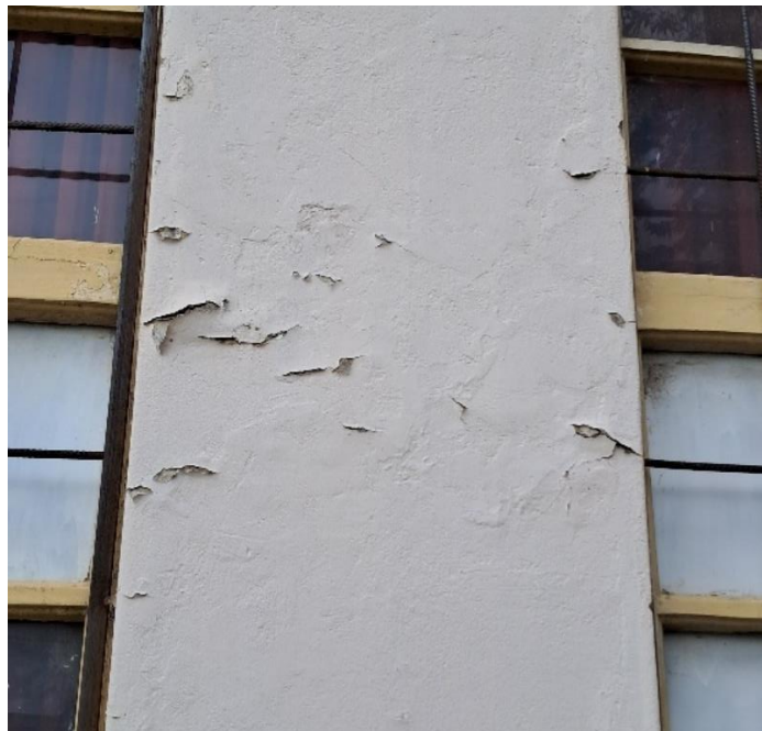
Figura 24. Descascaramiento de acabados en la cara exterior de la columna.
