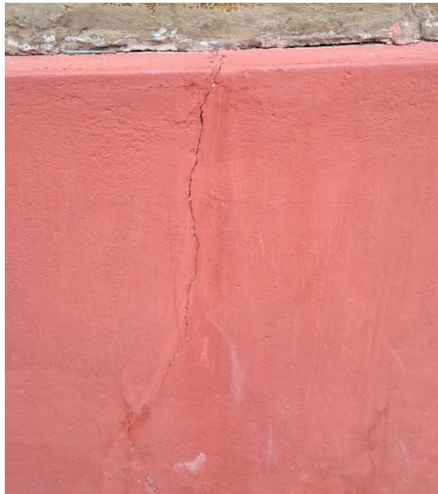
Figura 22. Presencia de fisura vertical en el zócalo de la I.E.R.L.G.
