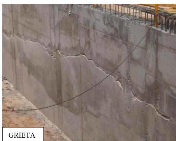
Figura 4. Grieta en muros
