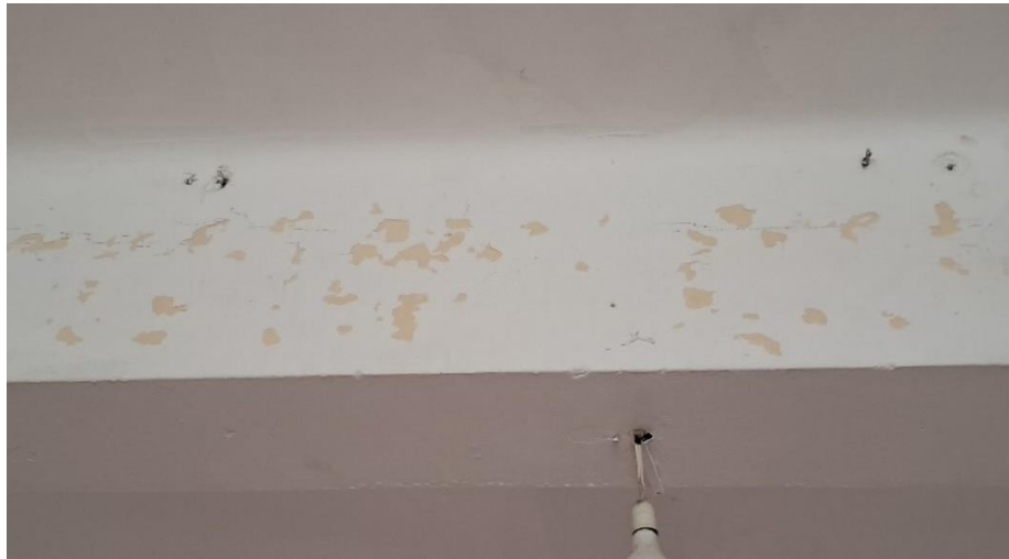
Figura 21. Erosión física en la viga del primer nivel de la I.E.R.L.G.
