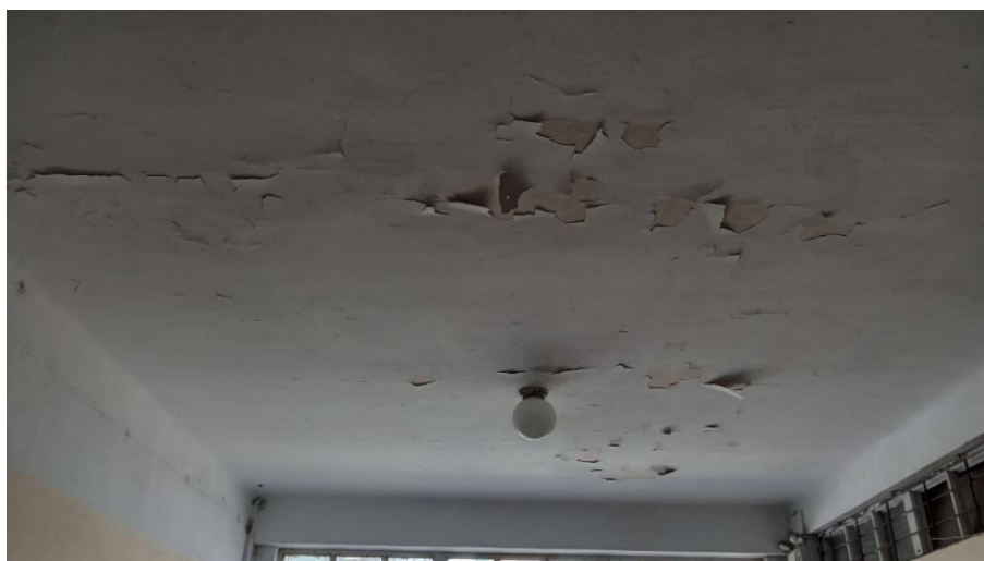
Figura 16. Patologías por erosión física en el techo de la Institución Educativa
