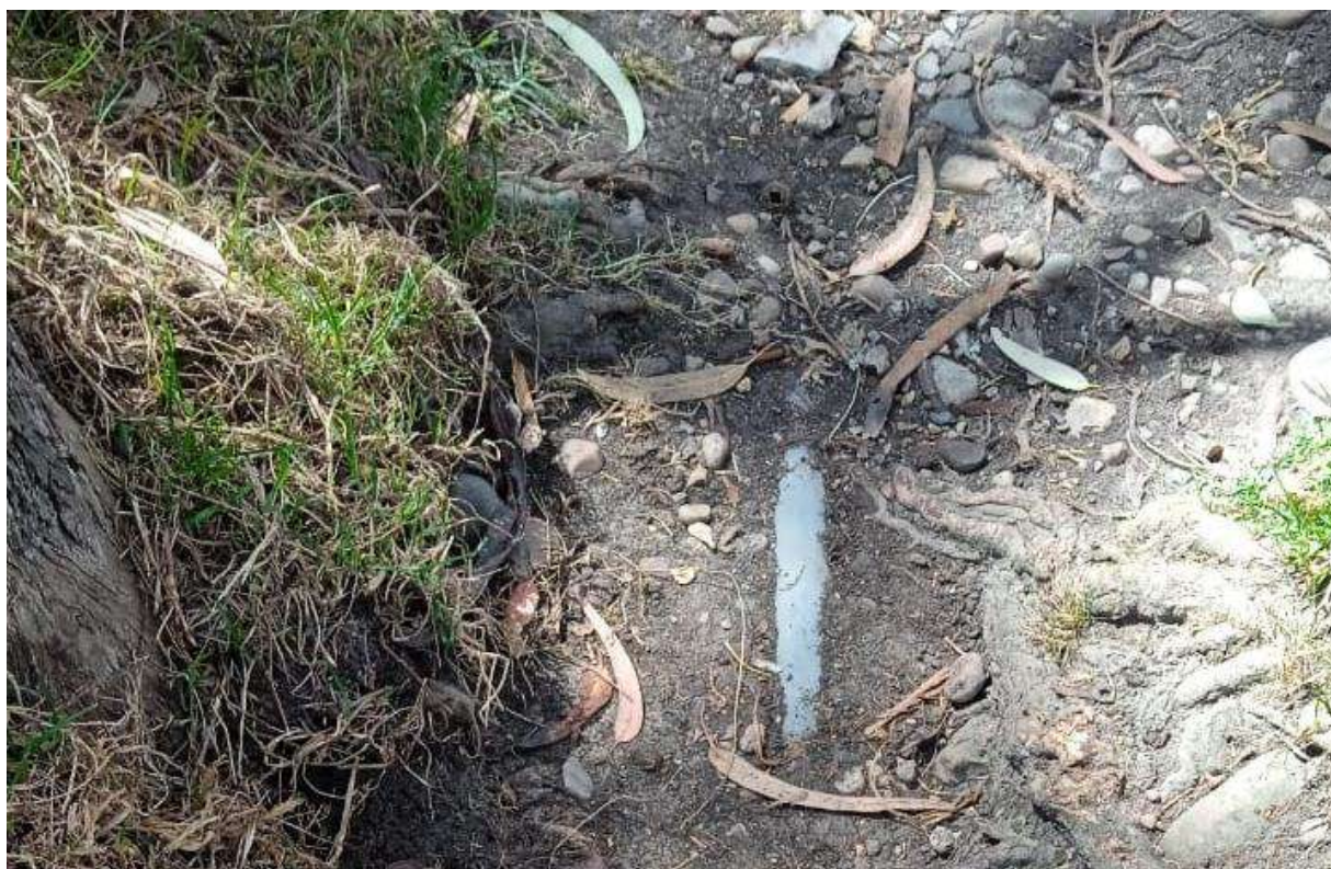
Figura 42: Tubería expuesta en la de red de distribución.
