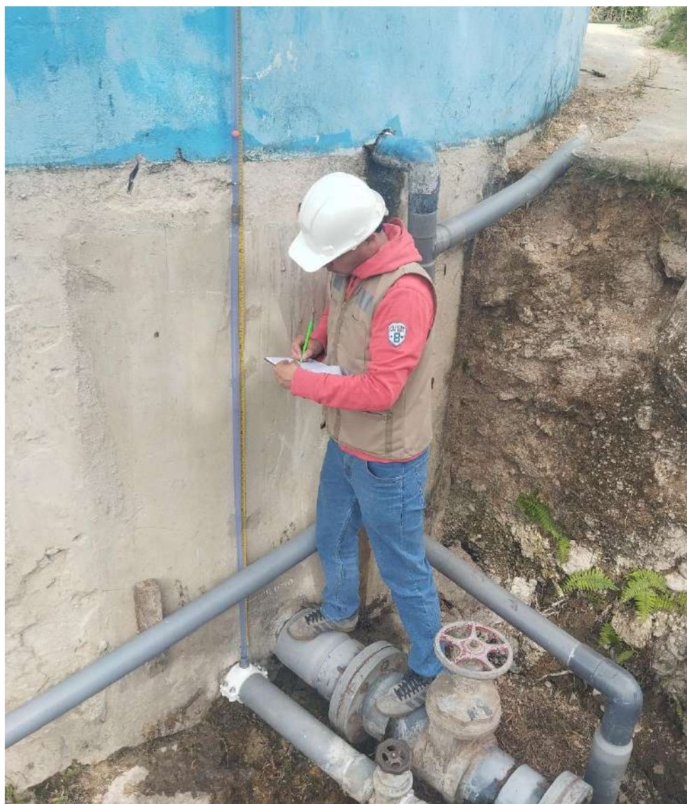
Figura 40: detalle de tubería de salida del reservorio
