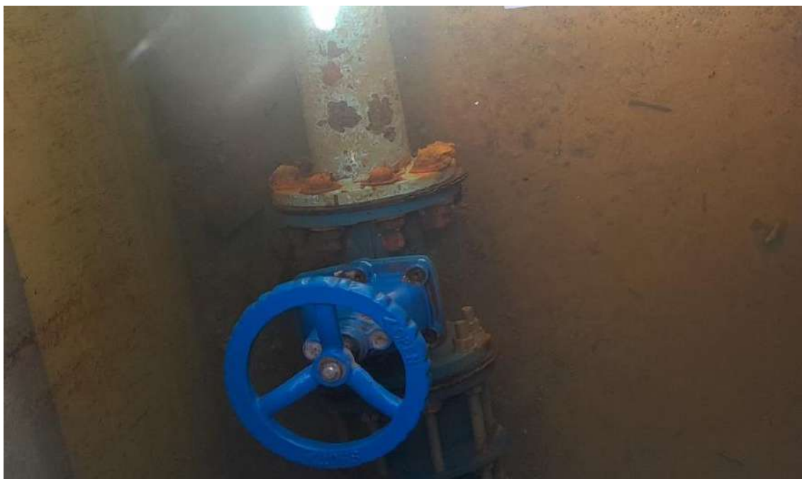
Figura 26: Cámara seca de la captación N.º 1
