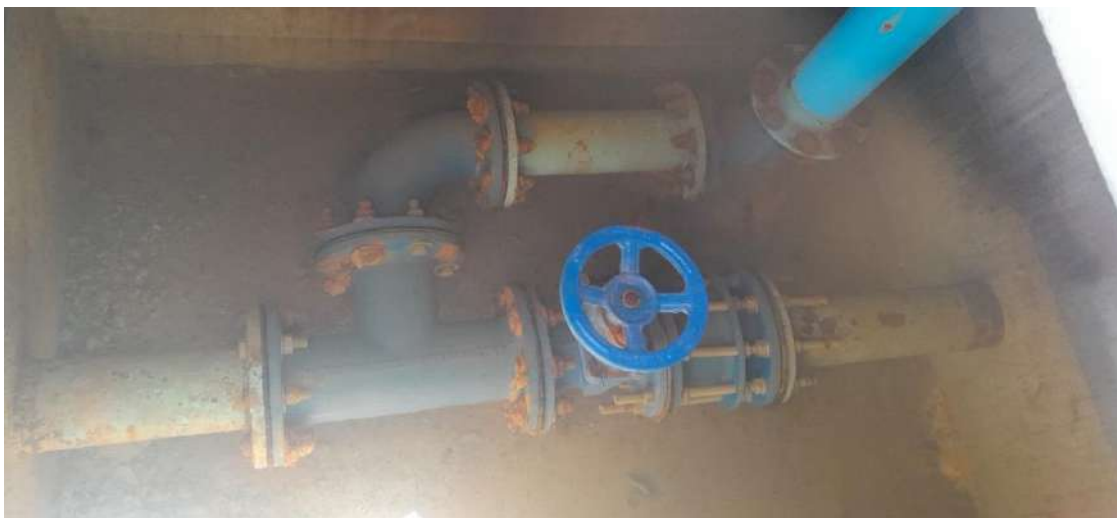
Figura 30: Cámara seca de la captación N.º 2
