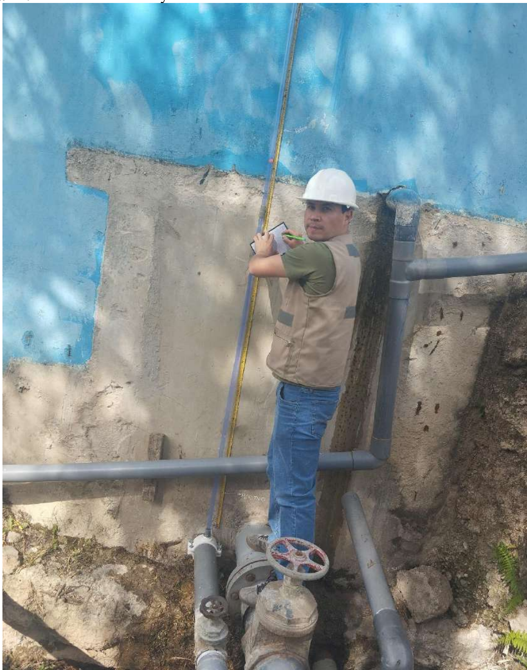
Figura 41: estado del concreto y tuberías de salida en reservorio circular
