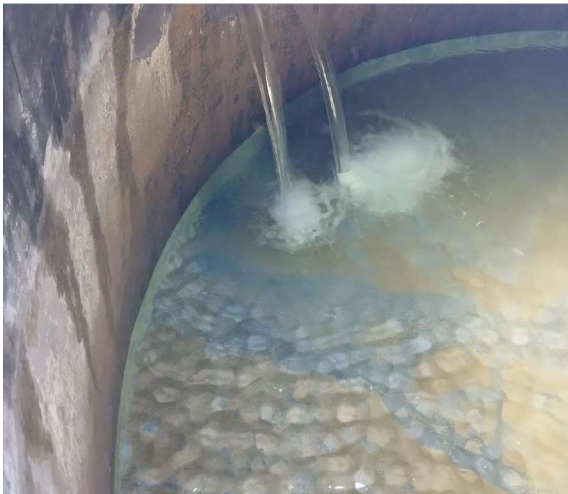
Figura 39: Interior de reservorio
