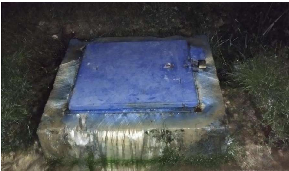
Figura 58: Rebalse de caudal en la cámara N°.2 en época de lluvias.
