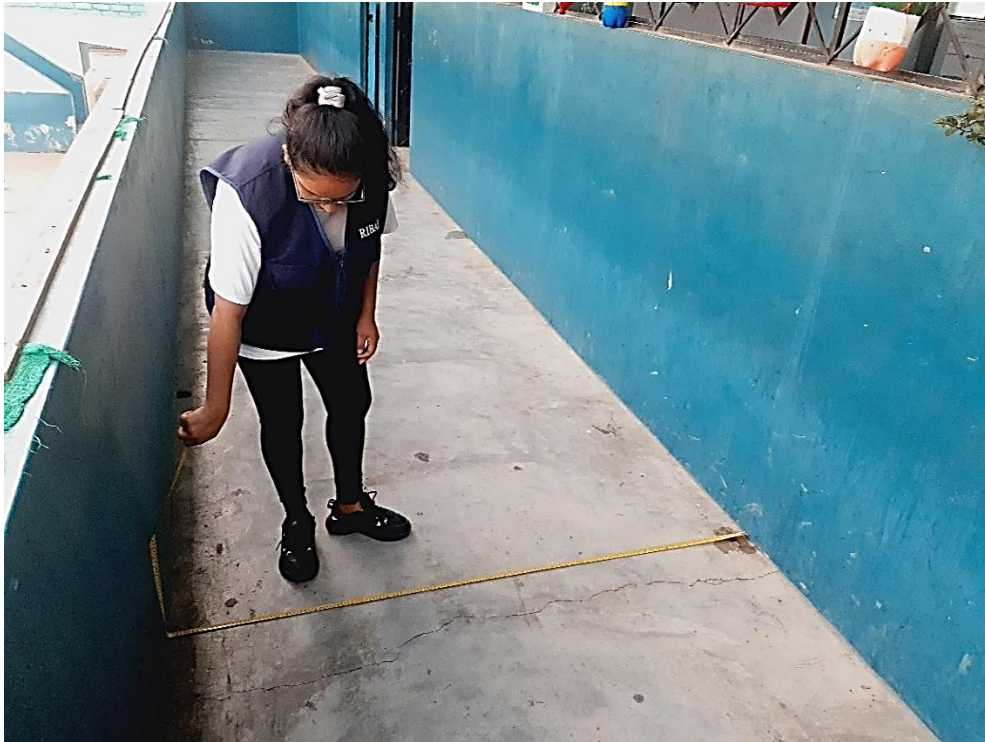
Fotografía N° 19. Se muestra una fisura que abarca el ancho del pasadizo del primer nivel (bloque 02) en el Tramo 09-10/ tramo E-H.
