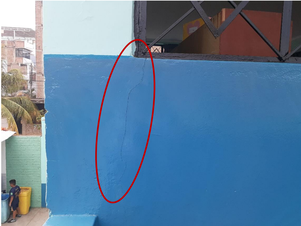
Fotografía N° 21. Se muestra una fisura ( L = 0.40 m) en la esquina del muro bajo (ventana) del segundo nivel (bloque 01) en el Eje 1-1/ tramo F-F.
