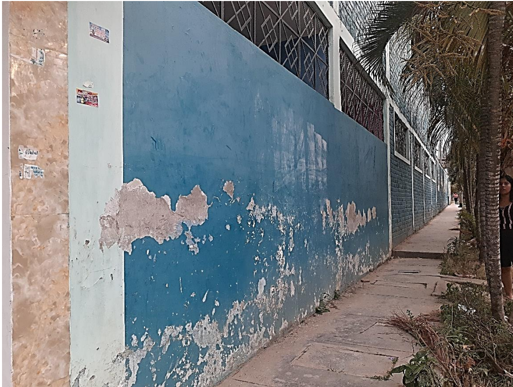
Fotografía N° 9. Se muestra patologías como erosión física, suciedad y humedad en la fachada de la Institución Educativa
