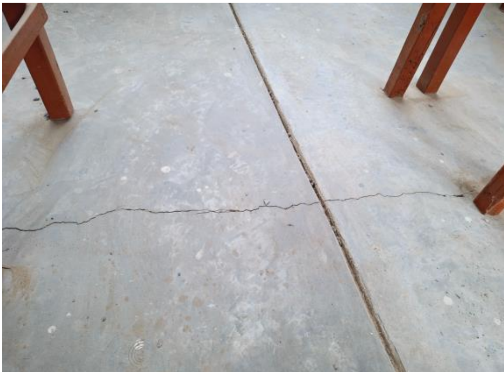
Fotografía N° 22. Se muestra una fisura con gran longitud que se expande por 03 ambientes ( L = 23.00 m) en la losa del primer nivel (bloque 02) en el eje 6 -12/ tramo B-E.
