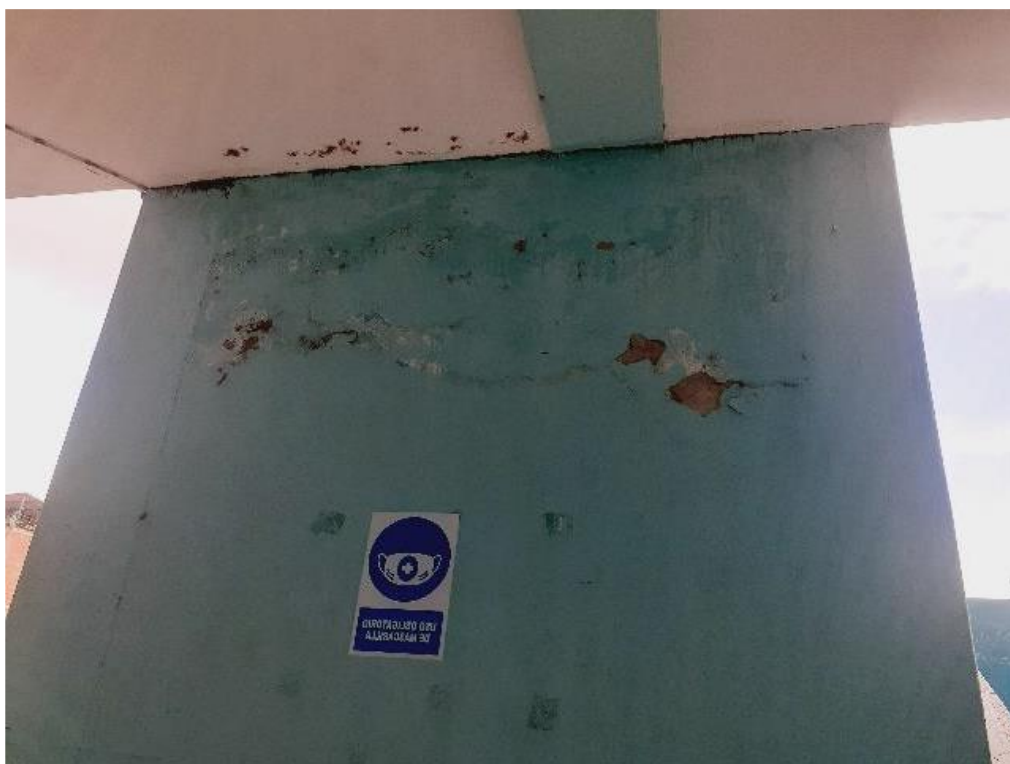
Fotografía N° 12. Se muestra Humedad, suciedad y erosión física en el muro de la escalera 01 (bloque 01) en el Eje G-G / tramo 13-14.
