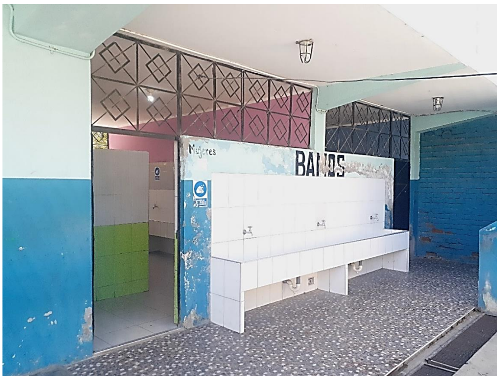
Fotografía N° 10. Se muestra erosión física, suciedad y humedad en el muro y columna del primer nivel (bloque II) en el Eje E-E / tramo 10-12.
