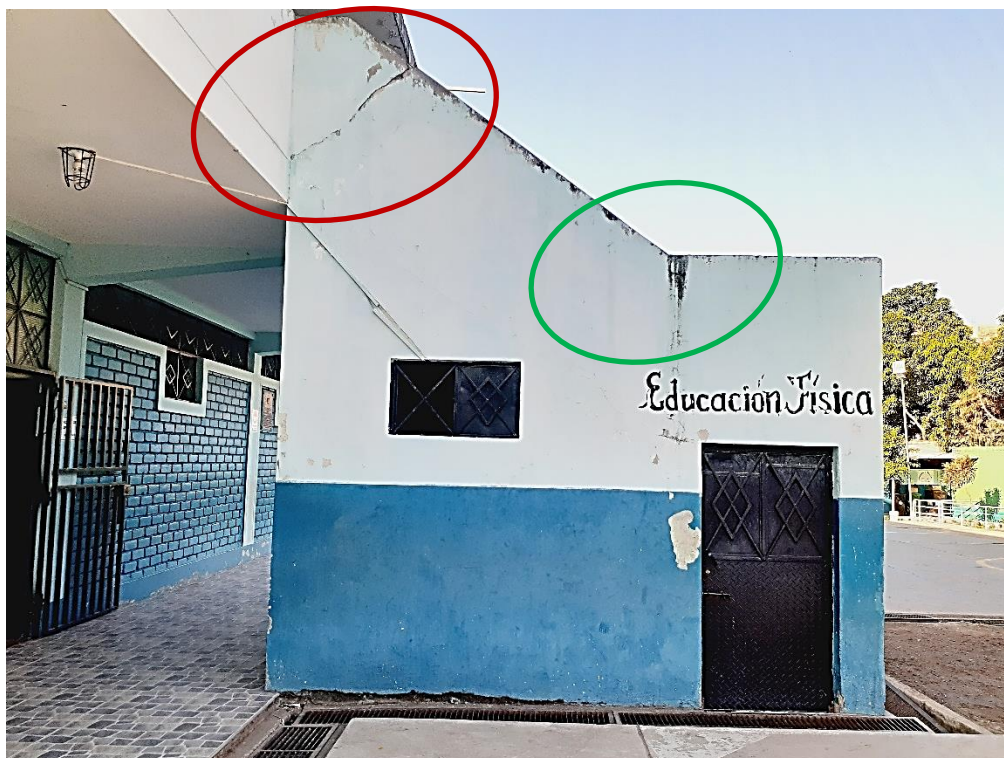
Fotografía N° 16. Se muestra una fisura (L= 0.90 m), hongos y Moho en el muro de la escalera 01(bloque 01) en el Eje 13 -13/ tramo G-J.
