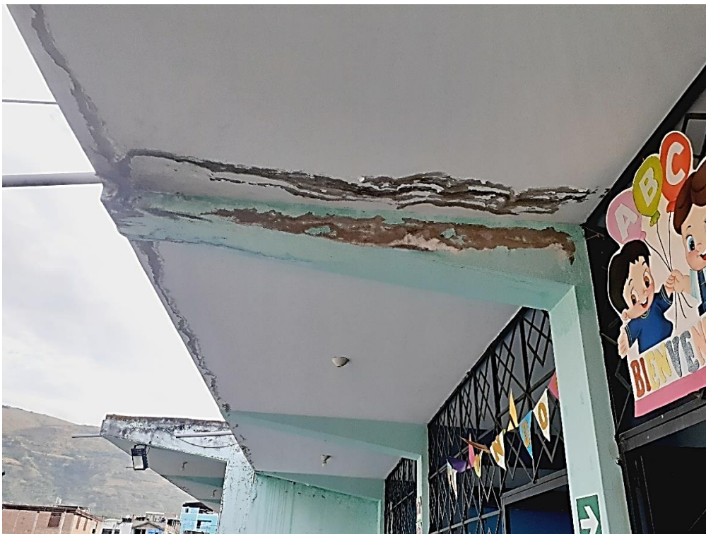
Fotografía N° 18. Se muestra erosión física, suciedad y humedad en la viga principal y losa del segundo nivel (bloque 02) en el Eje 8-8/ tramo E-H.
