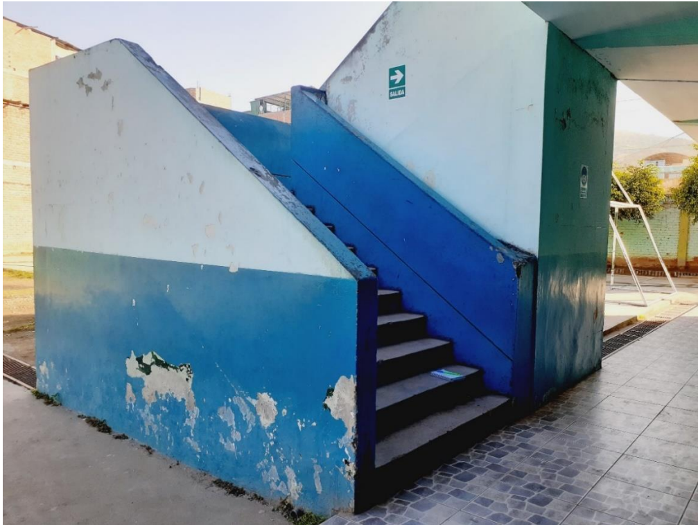
Fotografía N° 13. Se muestra Humedad, suciedad y erosión física en la escalera 01(bloque 01) Eje 14-14 / tramo G-J
