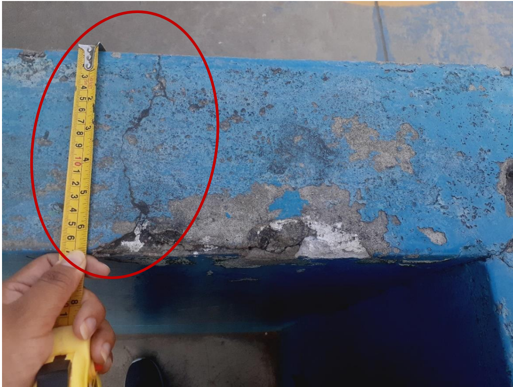
Fotografía N° 17. Se muestra una fisura ( L = 0.15 m), humedad, desprendimiento de concreto en el muro de la escalera 01 (bloque 01) en el Eje J-J / tramo 13-14.
