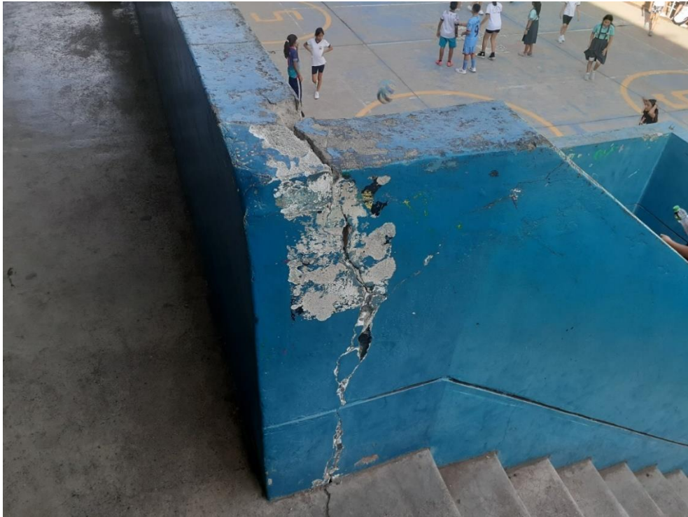
Fotografía N° 15. Se muestra una grieta (L= 1.00 m), erosión física y desprendimiento de concreto en la escalera 01(bloque 01) en el Eje 13 -13/ tramo G-J
