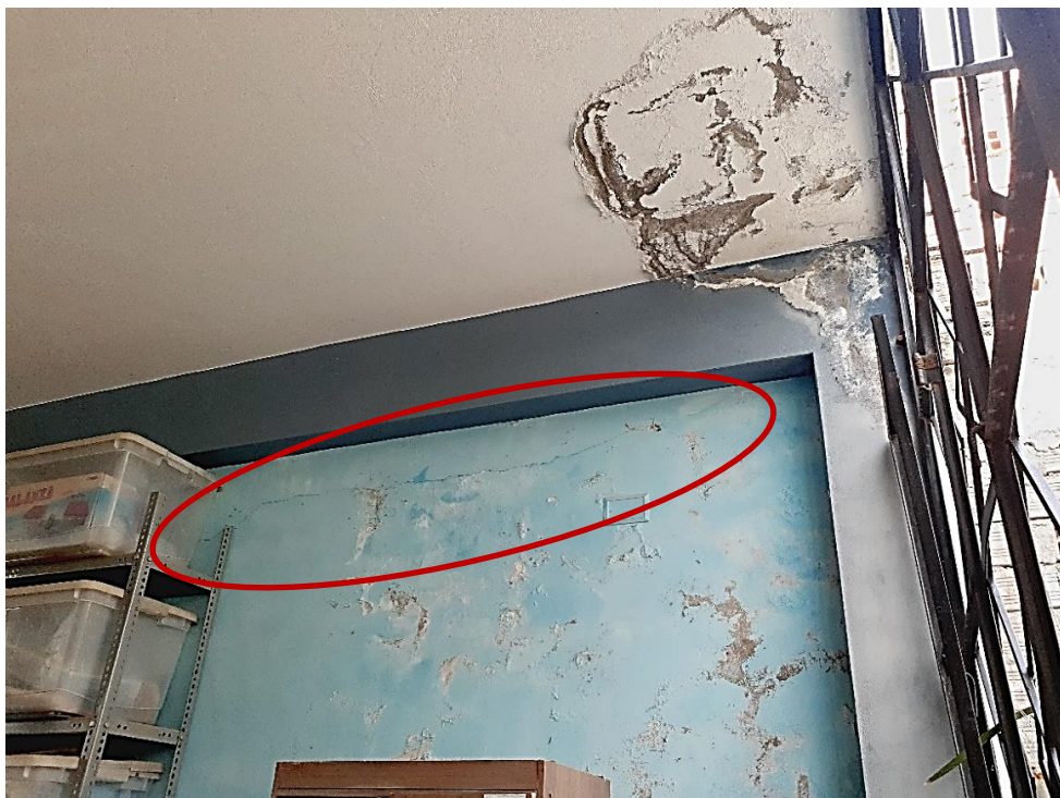
Fotografía N° 20. Se muestra humedad, erosión física suciedad y eflorescencia que abarca la columna, viga principal y la losa aligerada, incluso en el muro se aprecia una fisura (L=3.60m) en el segundo nivel (bloque 02) en el Eje 12-12/ tramo B-E.
